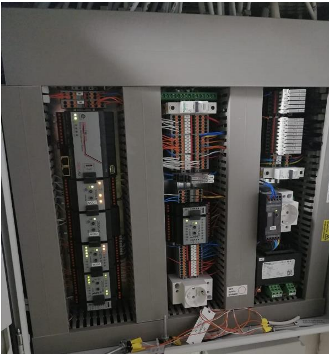
Kuva 42. Kytetty ja käyttöön otettu alakeskus.
