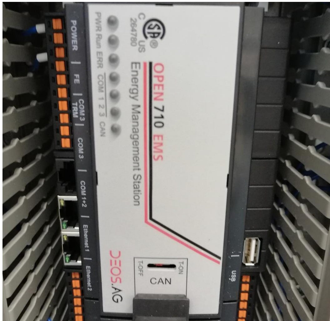
Kuva 21. OPEN EMS 710. Laitteiston CPU, johon liitetään tarvittavat moduulit.
