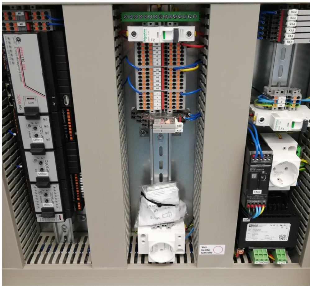
Kuva 40. Alkuperäinen alakeskus ennen lisätyötä.
