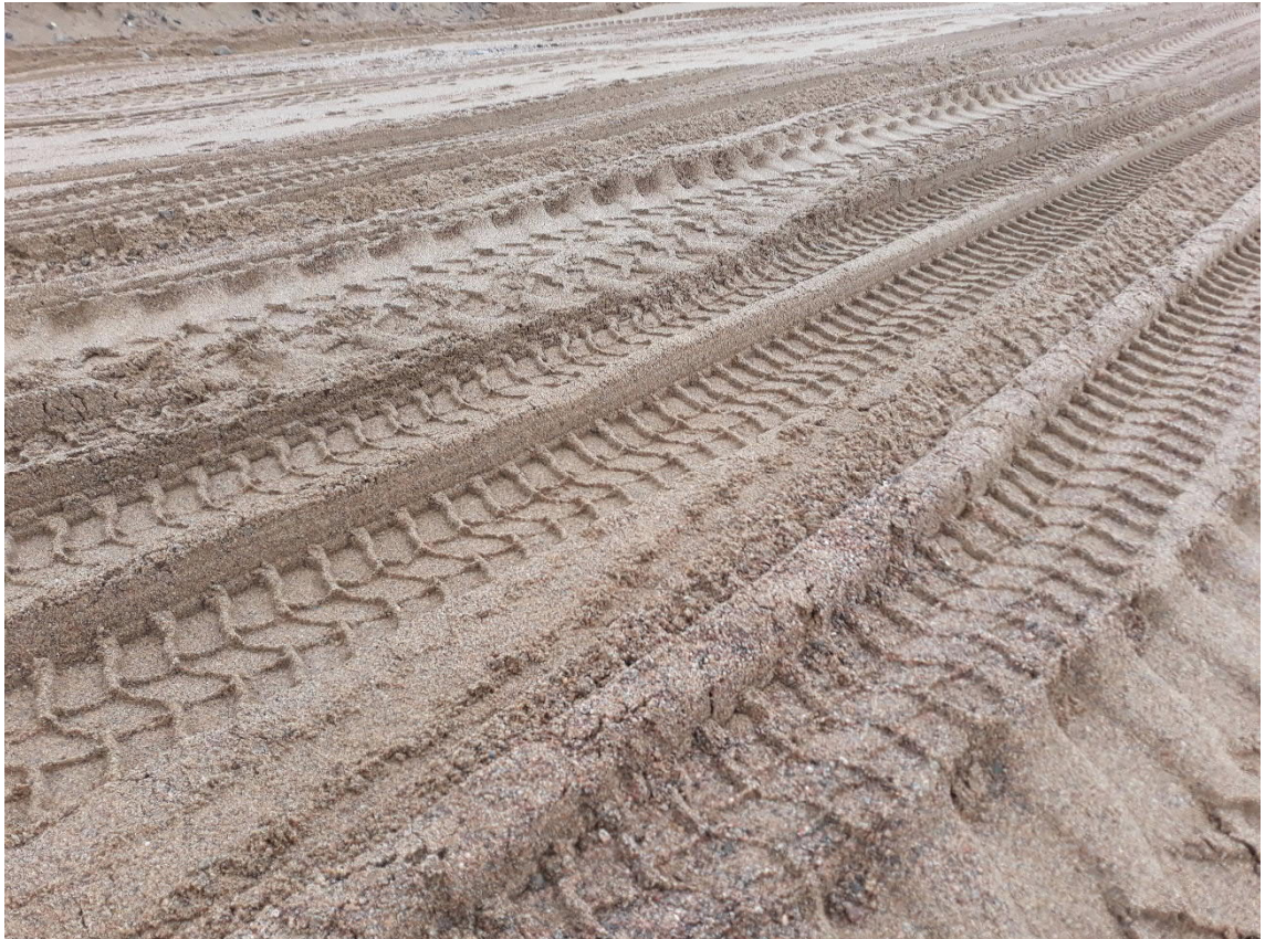
Kuva 21. Eristys- ja välikerrosmateriaalin tiivistämisiongelmiä. (Mika Lankinen)
