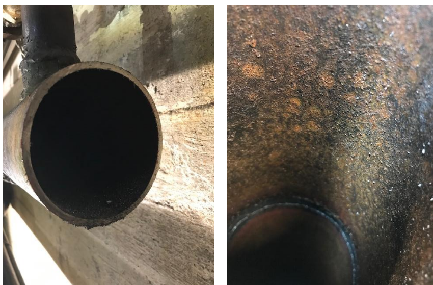
KUVIO 12. Putken sisäpinta runkolinjassa.
