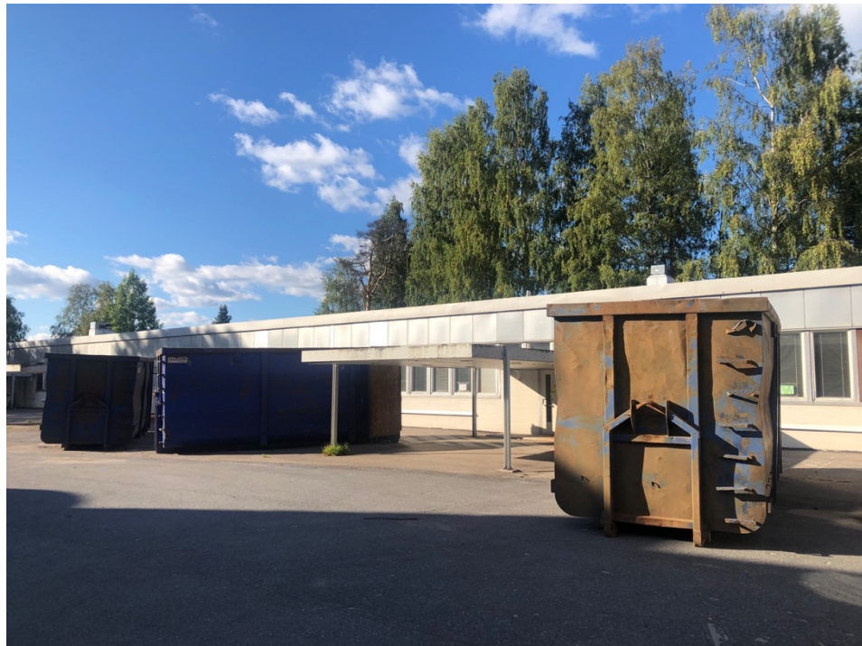
Kuva 1. Tainionkosken ala-asteen puolella sijaitseva piharakennus vuodelta 1960 puretaan vuonna 2020. Oviin on merkitty varoitus asbestista. (Kuva: Linda Nousiainen 2020)
