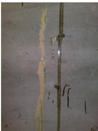
Kuvio 24. Injektointiaine valuu halkeamasta.
