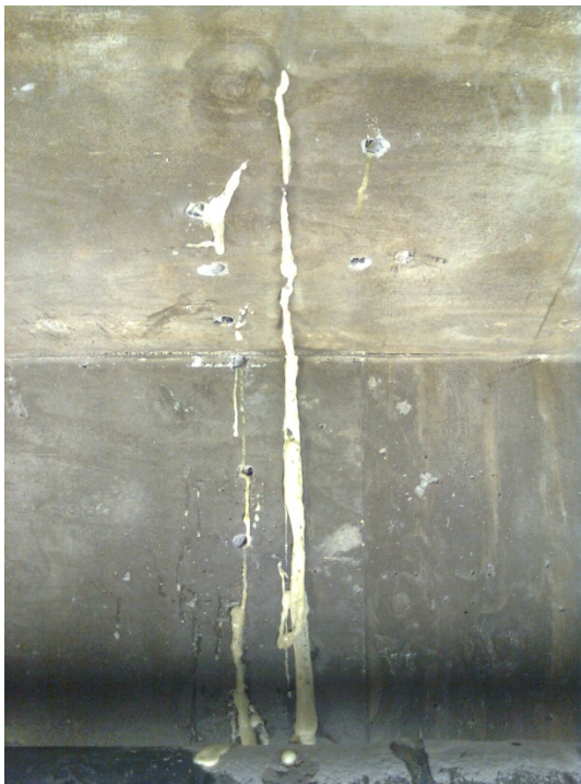
Kuvio 25. Injektoitu halkeama.
