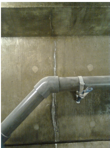
Kuvio 14. Itsestään tiivistynyt halkeama.
