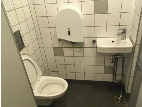
Kuva 12. Ilkivaltasyistä poistettu bidee yleisessä WC:ssä. Käsिसuihkun teline on jätetty seinään ja hanan bideeputki tulpattu messinkihatulla. [38]
