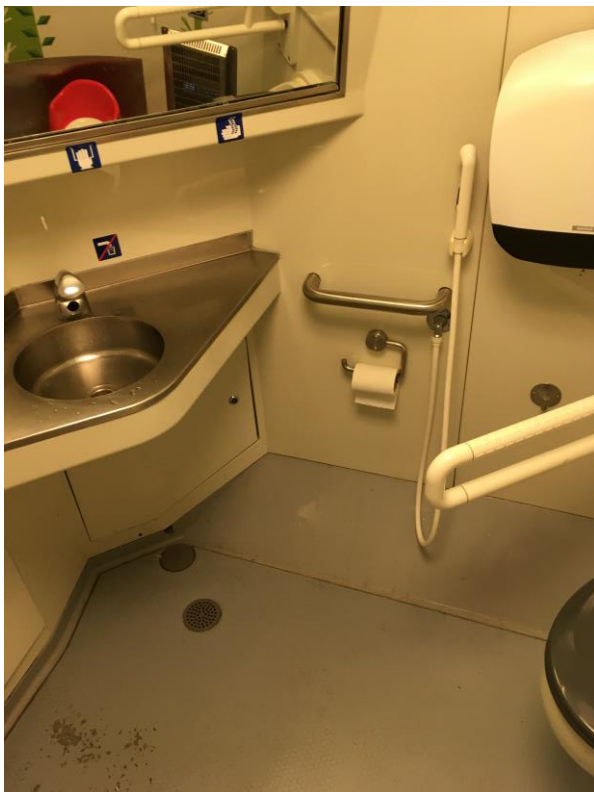
Kuva 19. Oras Electra Bidetta kuvattuna Intercity-junassa. Bideen käynnistyssignaali kulkee johtoa pitkin kalusteiden sisällä. Bideen putkitus on toteutettu piiloasennuksena kalusteiden sisällä. [38]
