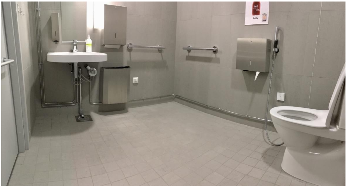
Kuva 21. Smart Bidetta -asennus liikuntaesteisten WC-tilassa. Bideen käynnistysignaali välitetään radioteitse bideetelineeltä keskusyksikölle. Hanan keskusyksikkö on pesualtaan alla. Pinta-asenteinen kuparinen bideeputki kulkee seinää pitkin bideesuihkulle WC-istuimen viereiselle seinälle. Bideekahva ja -teline ovat kuvan oikealla puoliskolla paperitelineen vieressä. Suihkuletku makaa lattialla haitaten lattian siivoamista. [38]
