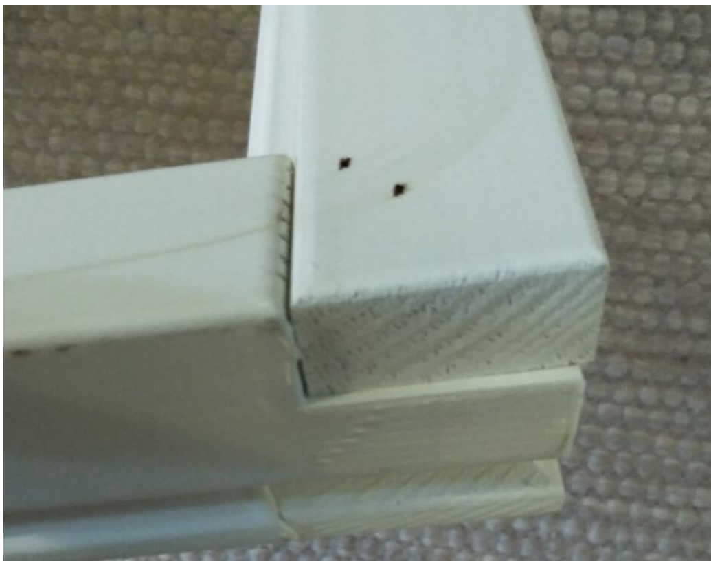
Kuva 5. Naulattu puiteliitos kuvattuna säärasituksen jälkeen
