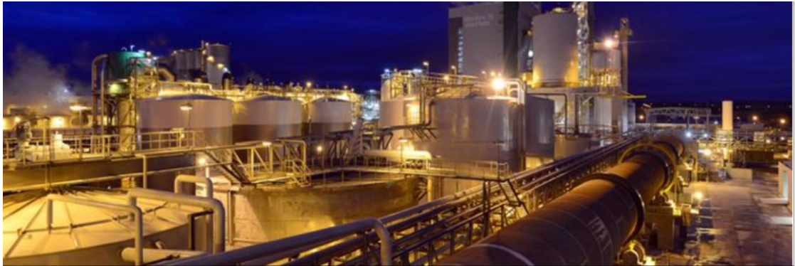
Kuva 1. Valkolipeälaitoksen sylinterimäinen meesauuni etualalla (Andritz 2020)
