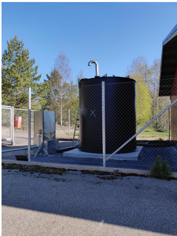
Kuva 7. Glyserolisäiliö puhdistamon piha-alueella.
