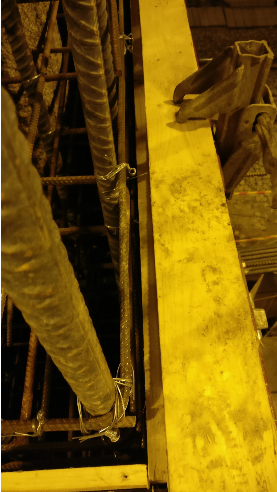
Kuva 14. Suojabetonin paksuus ei riittävä
