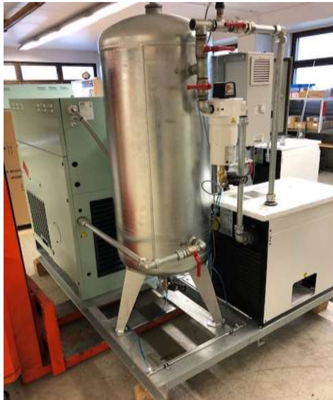
KUVA 12. Vanhan instrumentti-ilmayksikön nostotapa ja putkitus
