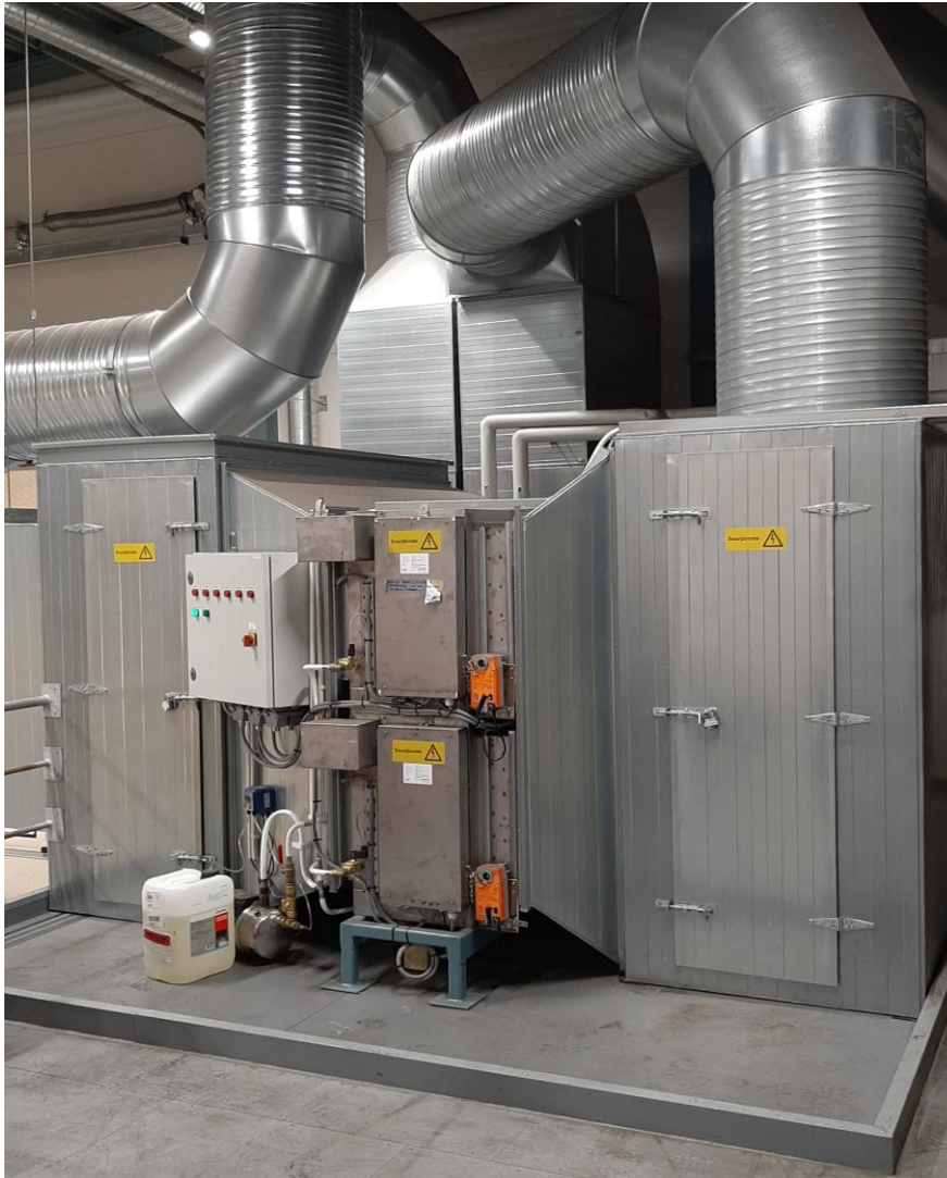
Kuva 10. Hymy sähkösuodatinyksikkö kanavistossa (Rauvola, 2019)
