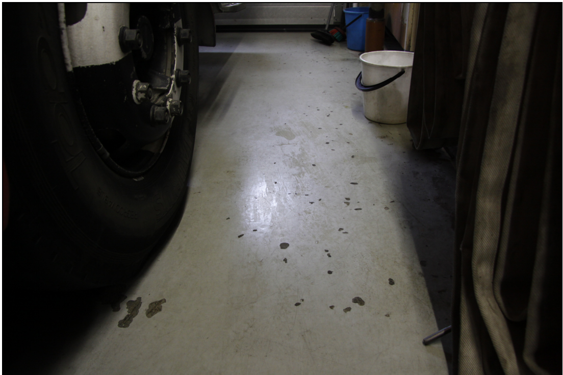
KUVA 4. Kalustohallin lattian pinnoituksessa on kulumista
