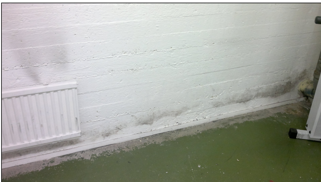
KUVA 3. Kuntosalin seinäpinnassa oli hometta
