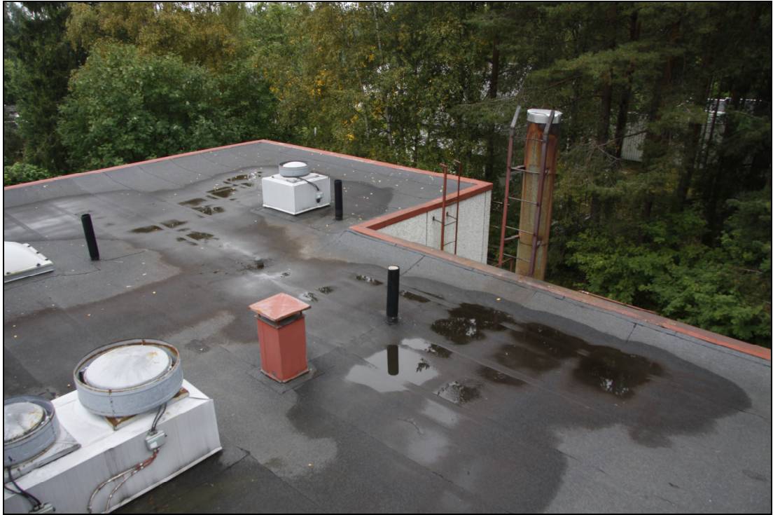
KUVA 1. Kohteen tasakaton veden "lätäköityminen"
