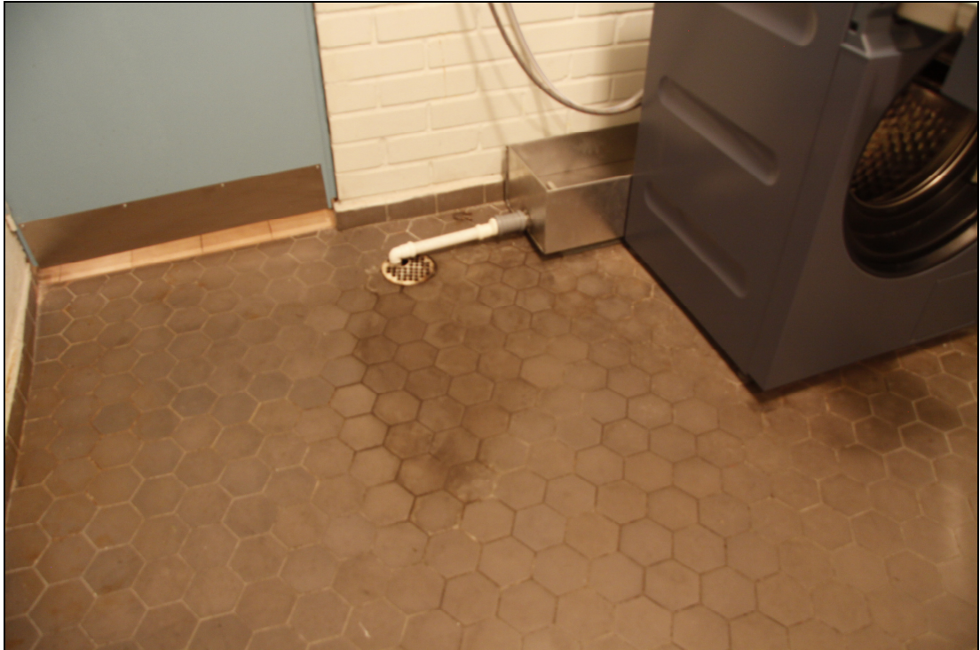
KUVA 6. Kuivaushuoneen lattiassa on kosteutta pesukoneen poistoviemä-röinnin puutteiden vuoksi
