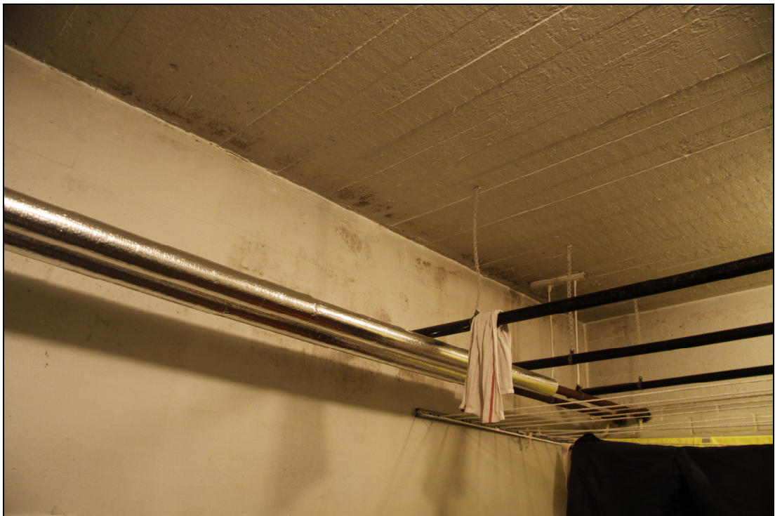
KUVA 5. Kuivaushuoneen katossa ja seinässä on havaittavissa hometta
