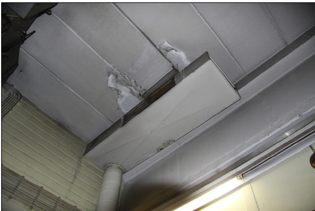
KUVA 2. Remonttihallin ilmanvaihdon poistokanavan läheisyydessä on havaittava kosteusvaurio
