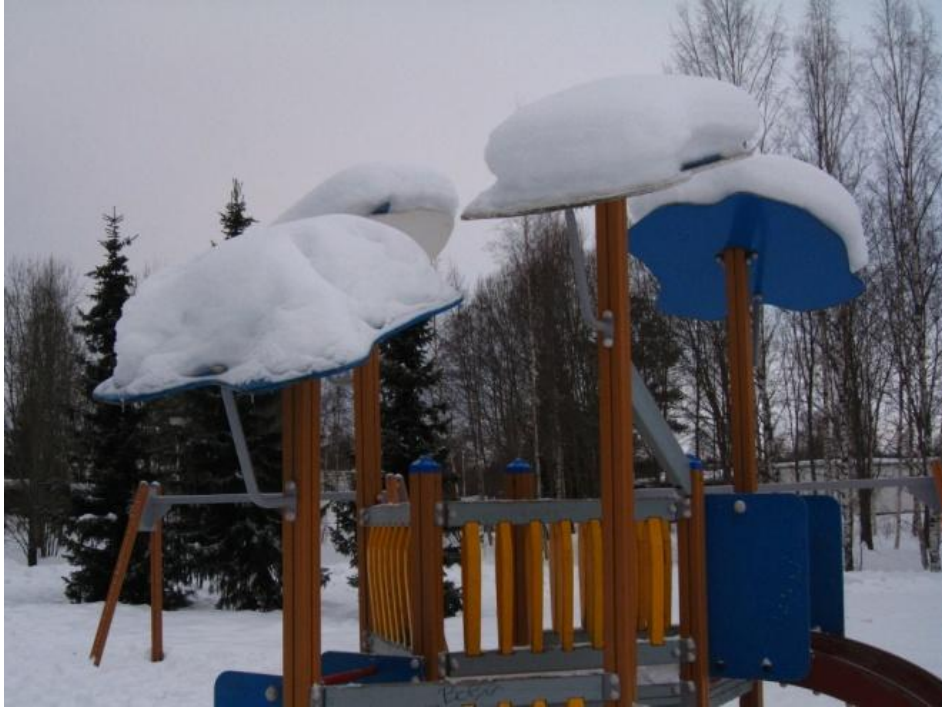
KUVA 9 Leikkivälineen katoksiin on jo alkutalvesta 2011 kerääntynyt paksut lumikerrokset. Kuva: Pilvi Pouttu 4.2.2011.
