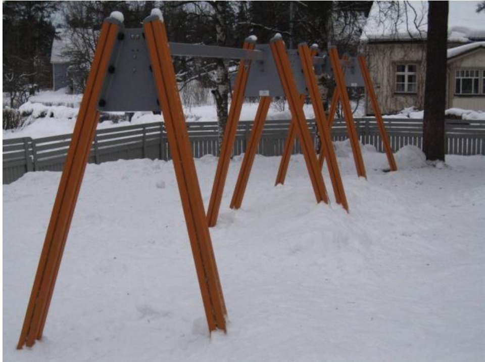
KUVA 5 Maa keinujen alla on erittäin epätasainen ja saattaisi aiheuttaa vaaratilanteen, jos keinuistuimet olisivat paikoillaan. Keinuistuimen ja maanpinnan etäisyys muuttuu helposti kielletyn kokoiseksi lumen pakkaantuessa maahan. Kuva: Pilvi Pouttu, 25.2.2011 Härmälän päiväkot, Tampere.
