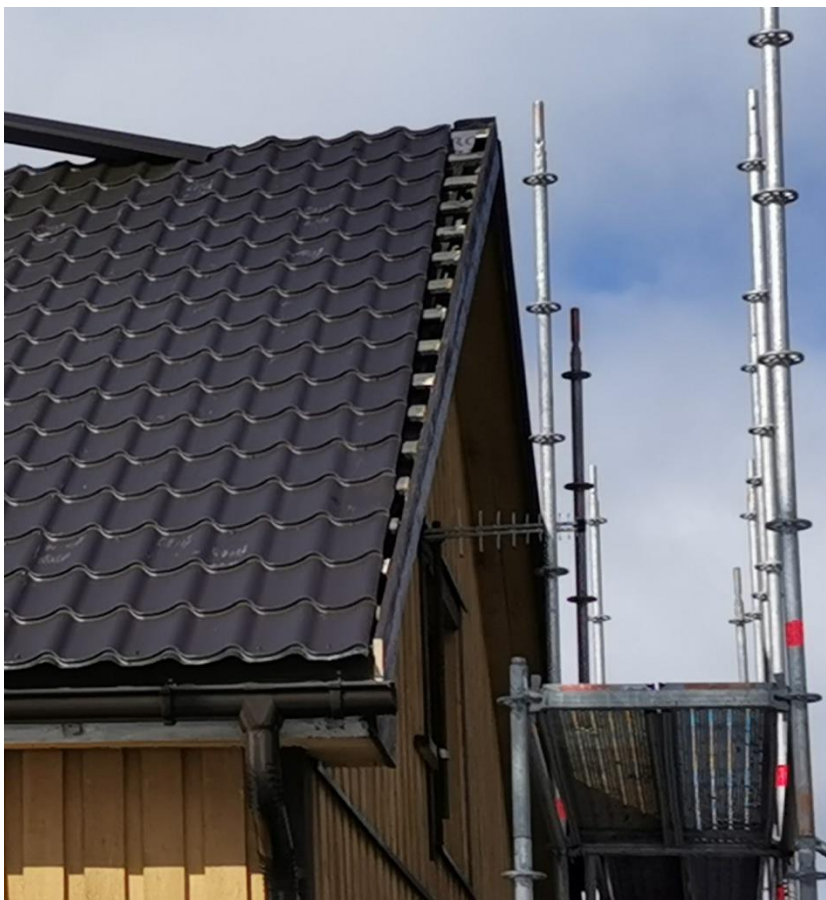
Kuva 28. Ristimita heiton aiheuttama ongelma.
