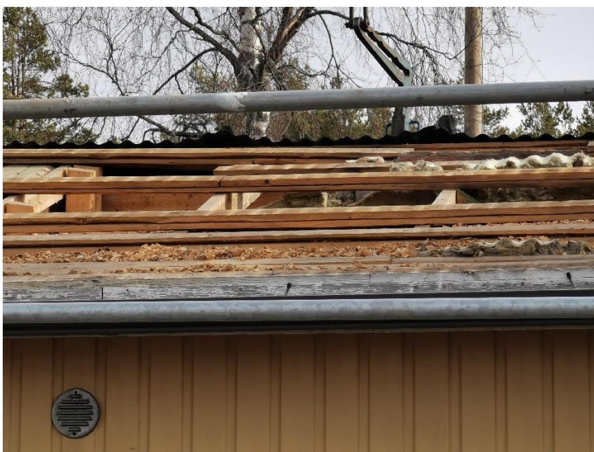
Kuva 18. Lisäsiivestä saunan kohdasta puuttui aluskate.
