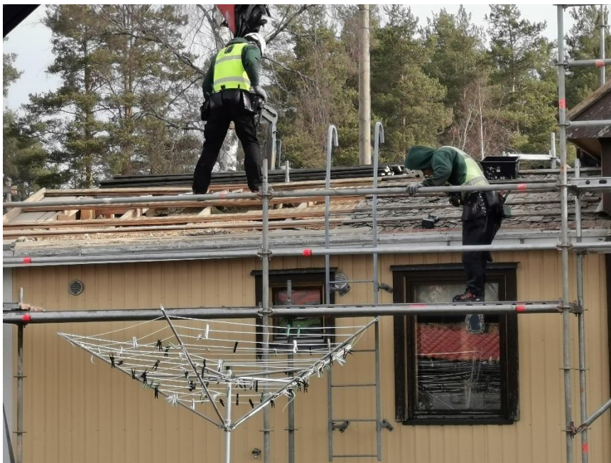
Kuva 17. Lisäsiivestä puuttui aluskate.
