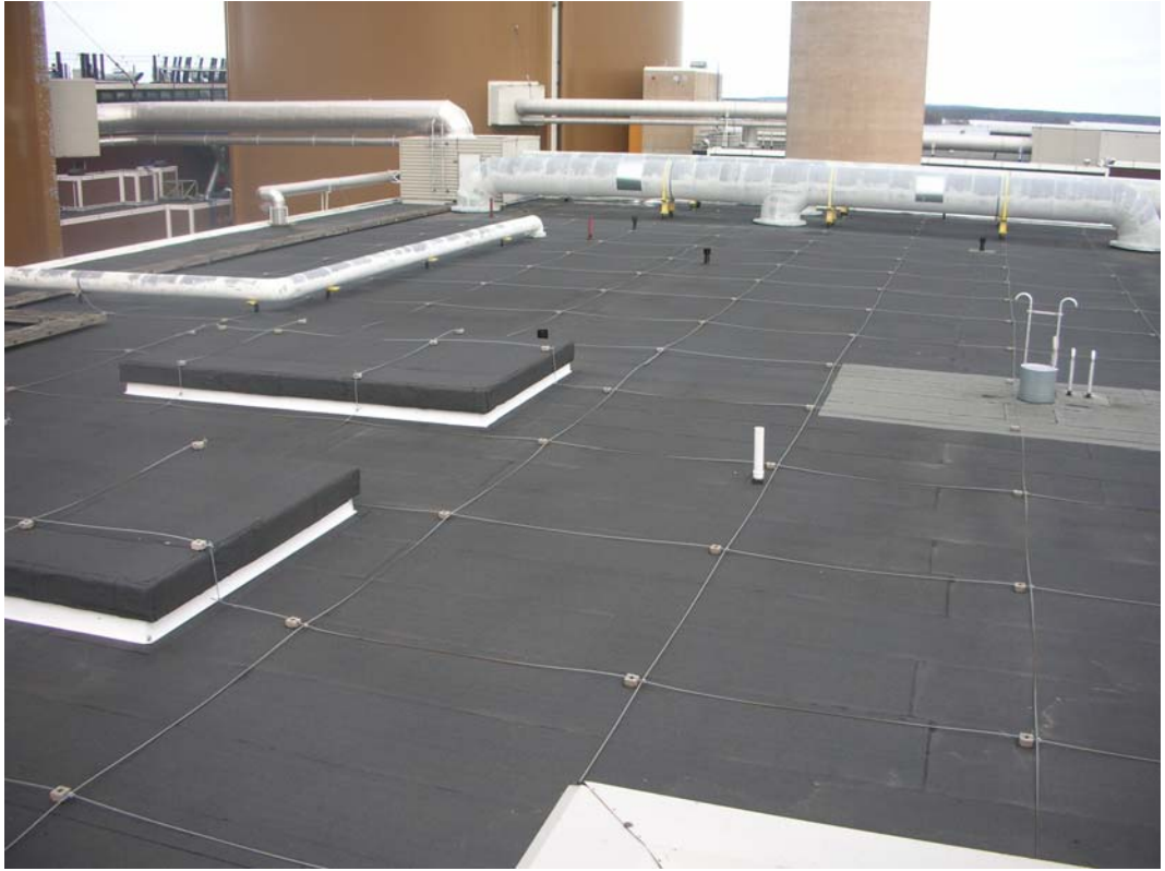
Kuva 10. Maadoitusverkko Lo1–apurakennuksen katolla
