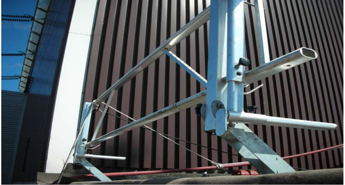
Kuva 5. Vastapainoturvakaiteet katon reunalla
