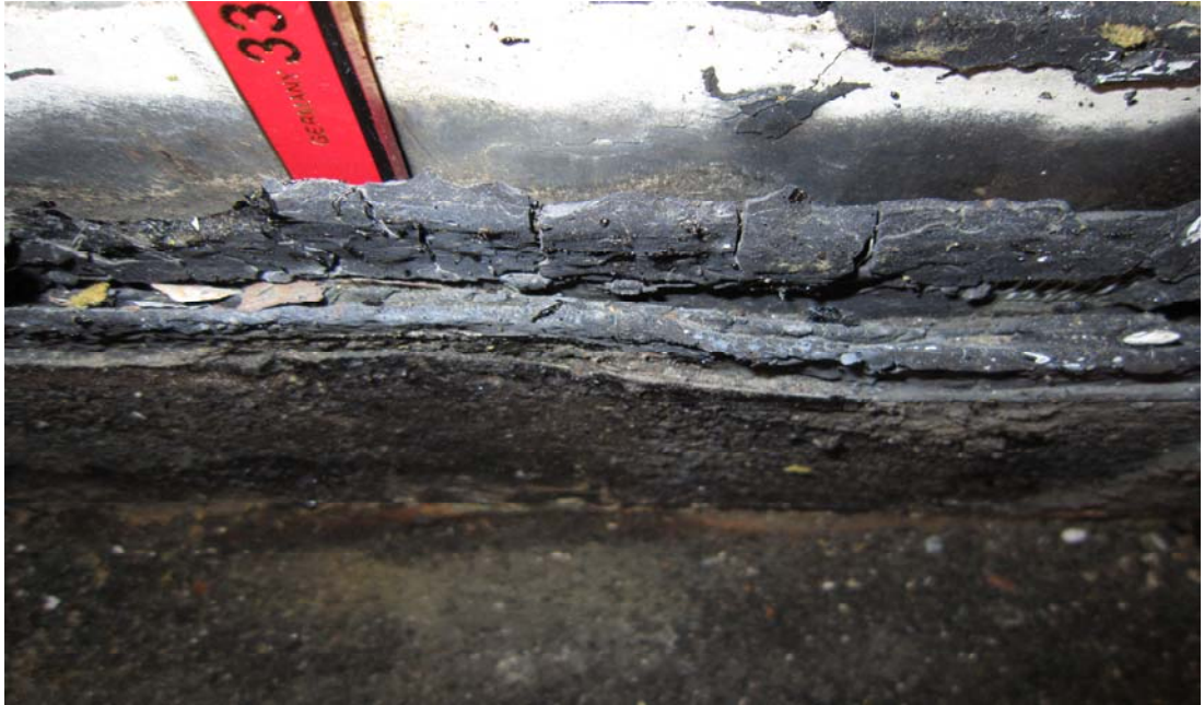
Kuva 3. Seinällennostot, jotka ovat irronneet alustastaan. Kynä on laitettu huovan ja seinän väliin, jotta vika näkyisi selvemmin.
