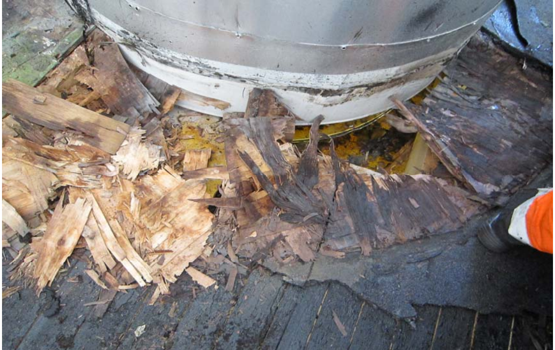
Kuva 9. Putkiläpiviennin vuotamisesta johtuvia rakennevaurioita
