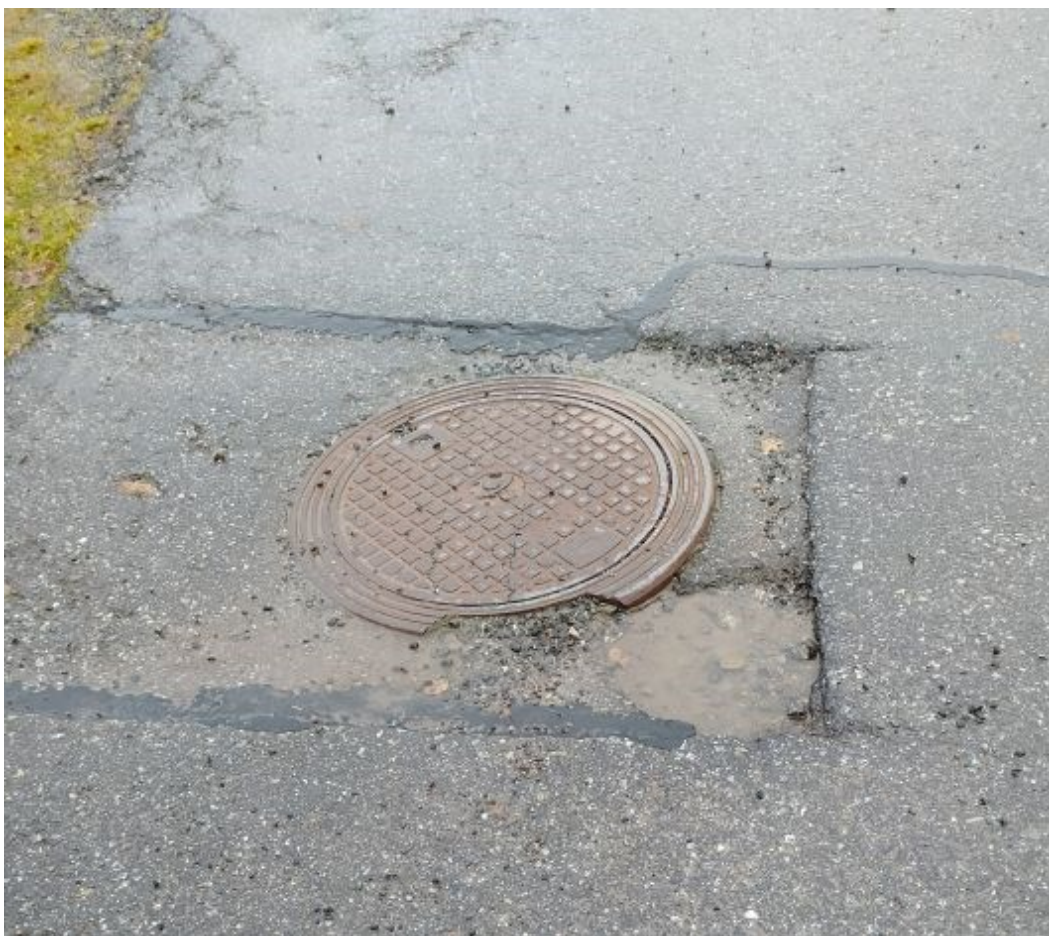
Kuva 2. Saumahalkeamasta lähtenyt purkauma Luutnantintiellä.
