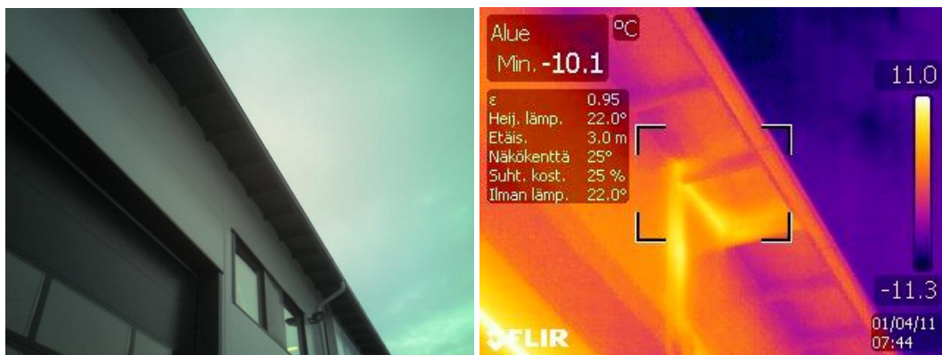
KUVA 10. Kylmäsilta Carrier Oy:n nosto-oven yläpuolella
