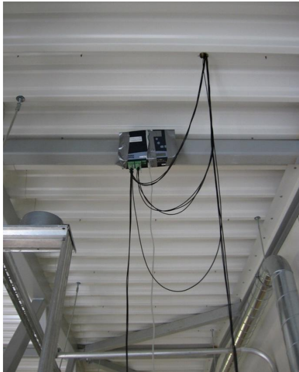
KUVA 7. Data Logger 2040 kiinnitettynä katonrajaan
