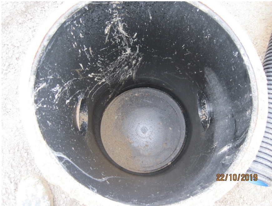
Kuva 10. Keräävä muovinen hulevesikaivo sakkapesällä. (Huikari 2019)
