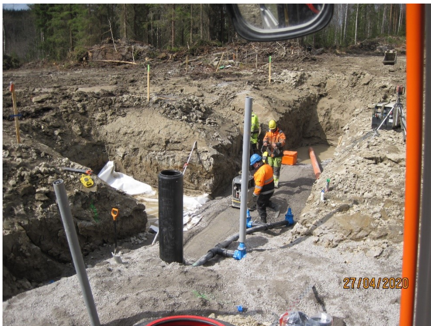
Kuva 8. Karan jatkot suoja-putkissa (Huikari 2019)
