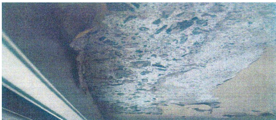
KUVA 2. Parvekelaatan alapinnan maalivauriota ja betonin pinnassa alkavaa pehmentymää (Palosaari & Moisanen 2009)
