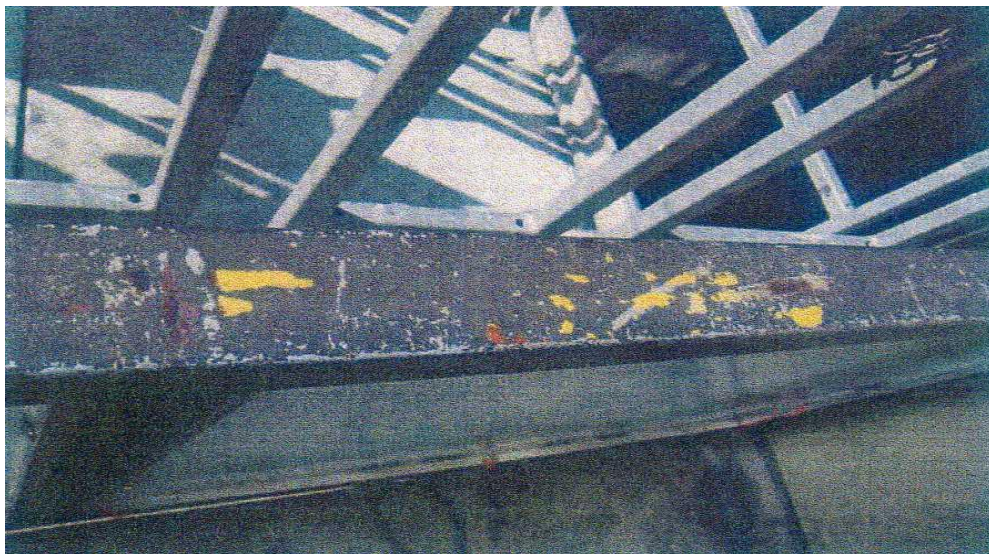
KUVA 5. Kaiteen teräsosien maali- ja korroosioauriot (Palosaari & Moisanen 2009)
