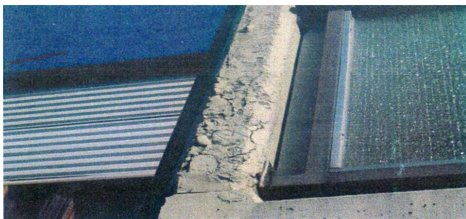
KUVA 3. Pieliseinän etureunan betonivaurioita (Palosaari & Moisanen 2009)
