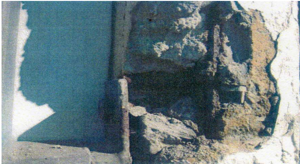
KUVA 4. Pieliseinän etureunan korroosioauriot ja betonin lohkeamia (Palosaari & Moisanen 2009)
