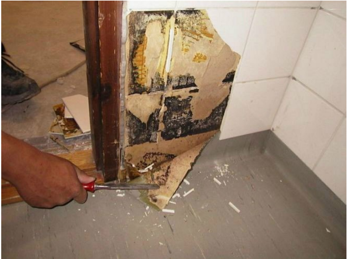
Kuva 5 Kosteusvaurioita kaakeleiden ja muovimaton alla.
