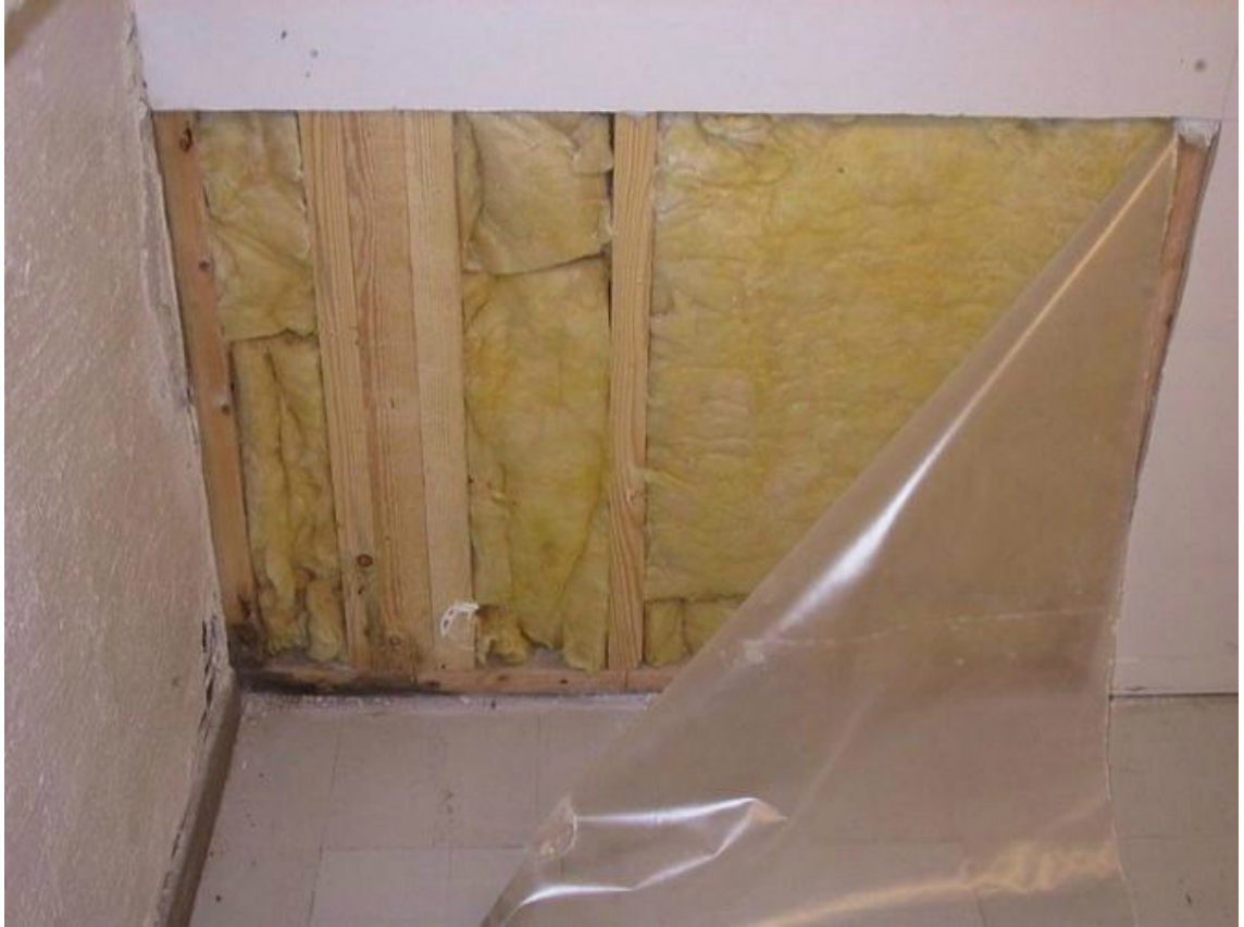
Kuva 2 Alajuoksupuoli ja osa pystyrungon alaosasta on mustunut. Puurakenteinen seinä liittyy maanvastaiseen betoniseinään.
