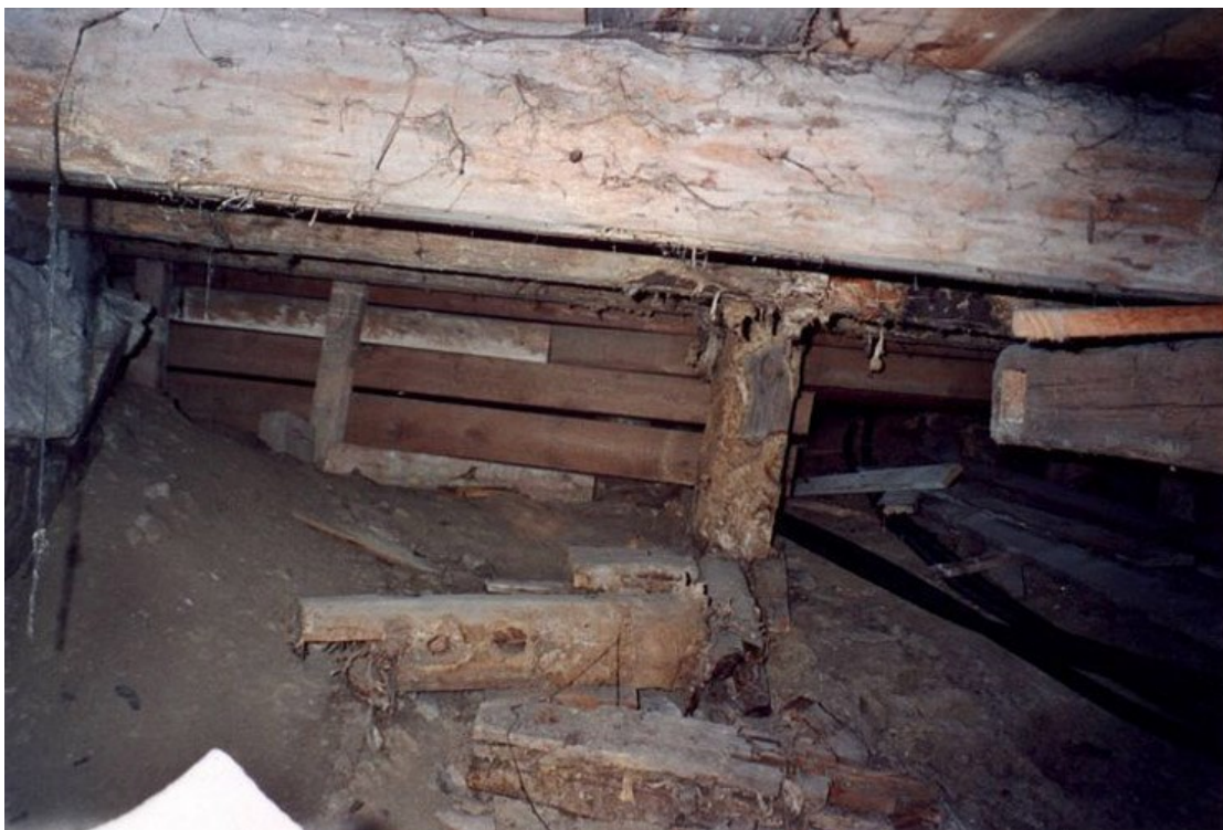
Kuva 8 Ryömintätilan tuuletuksen tukkimisesta, rakennuksen kylmillään olosta ja putkivuodoista aiheutunut lattiasieni on vaurioittanut 100-vuotiaan hirsirunkoisen kansakoulurakennuksen rakenteita. Lattiapalkeissa näkyy lattiasienen rihmastoja.
