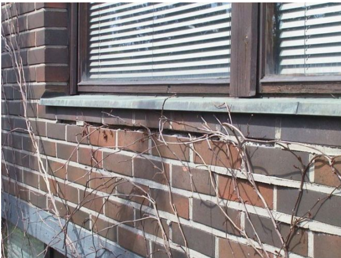
Kuva 4 Tiiliseinässä on rapautumaa ja ikkunapellissä ei ole kallistuksia. Sadevesi pääsee rakenteisiin saumauksen vauriokohdista.
