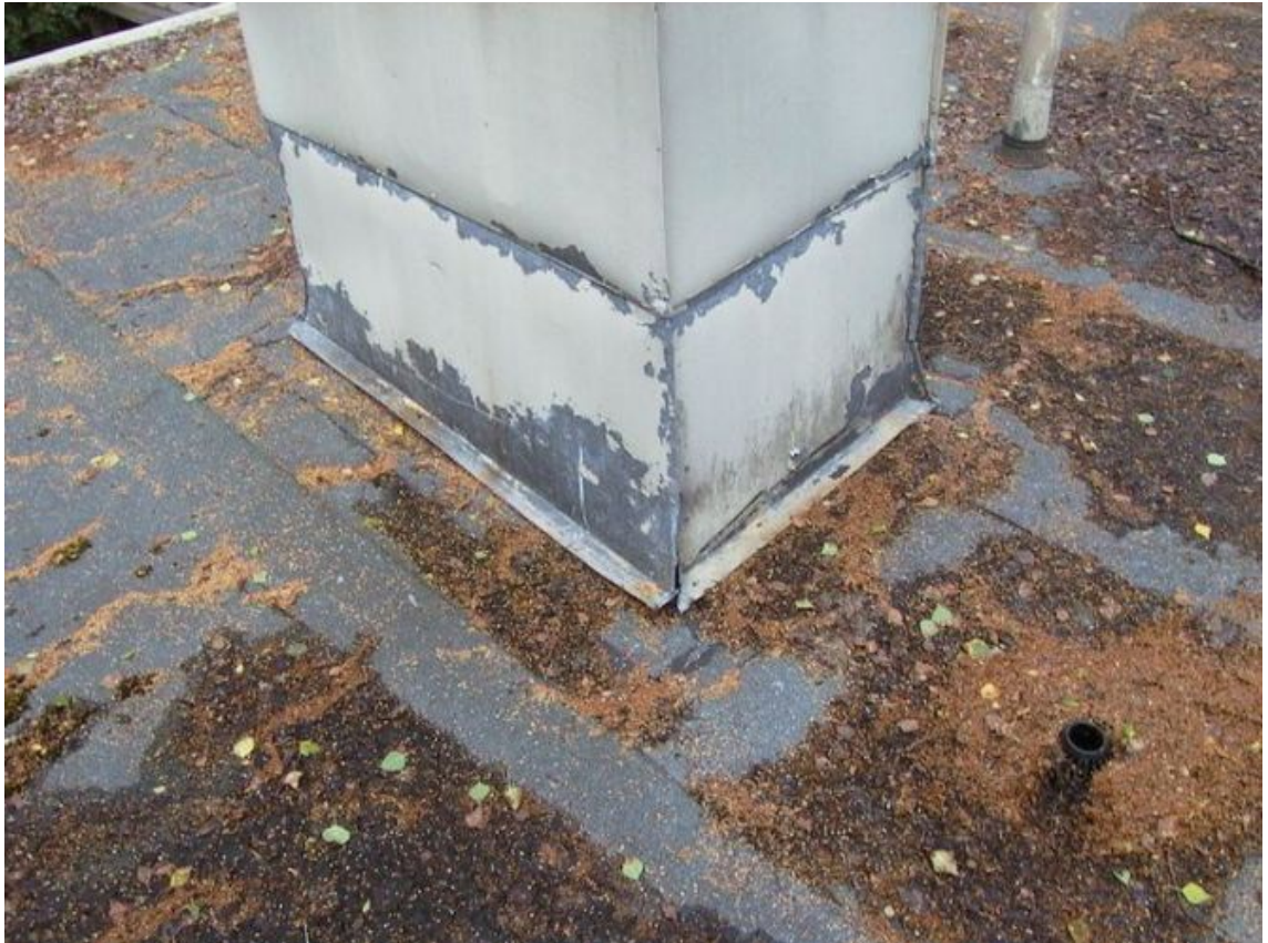
Kuva 3 Katolla on useita läpivientejä, kuten piippuja, tuuletusputkia ja kattokaivoja, jotka todennäköisesti vuotavat yläpohjaan. Pellitykset ovat huonokuntoiset.
