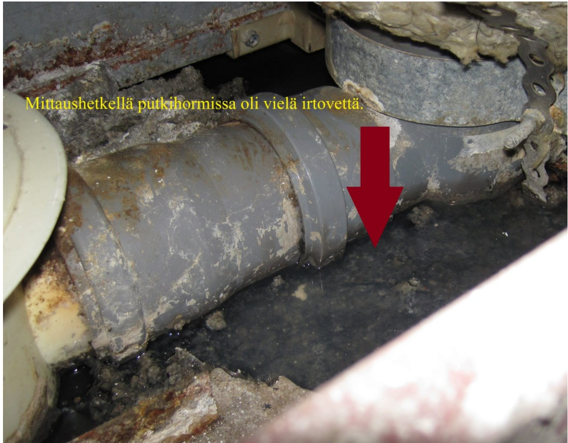
Kuva 1 Kuvan putki vuotanut ja aiheuttanut kosteusvaurion.
