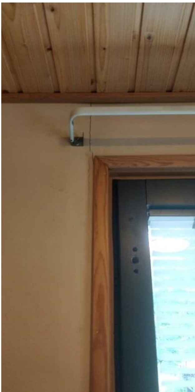
Kuva 10. Halkeama kipsilevysaumassa kolmannessa makuuhuoneessa.
