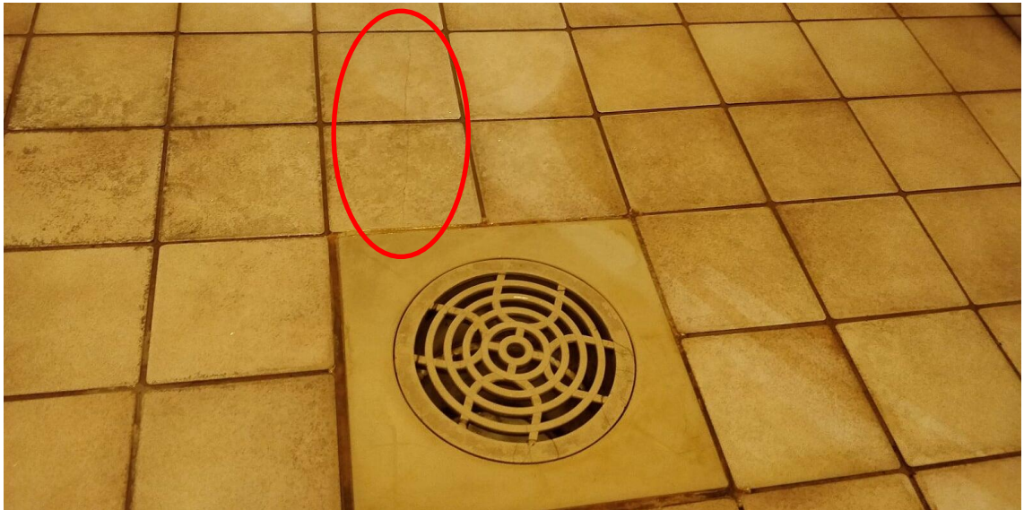
Kuva 14. Pesuhuoneen lattian haljenneet laatat.
