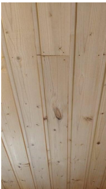
Kuva 9. Kodinhoitohuoneen katto, josta lakka on hilseillyt pois.
