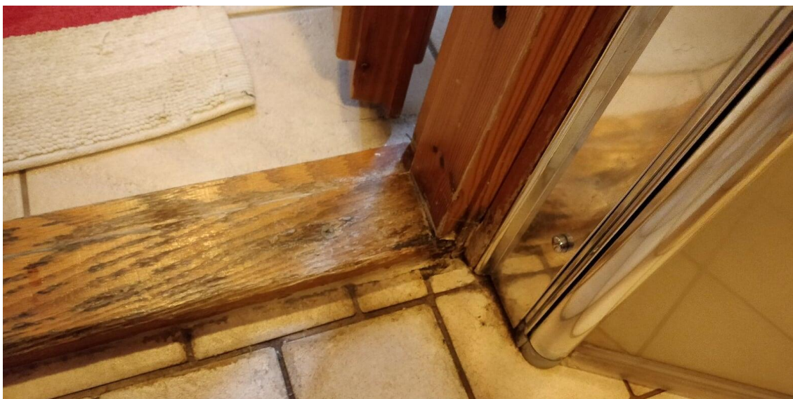
Kuva 11. Pesuhuoneen oven karmit ja kynnyks.
