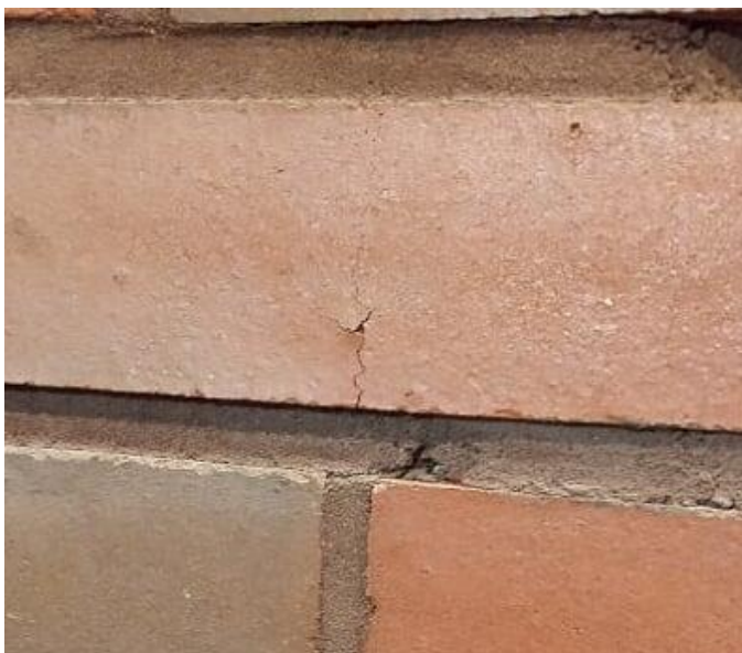
Kuva 16. Halkeama takan saumauksessa ja tiilessä.
