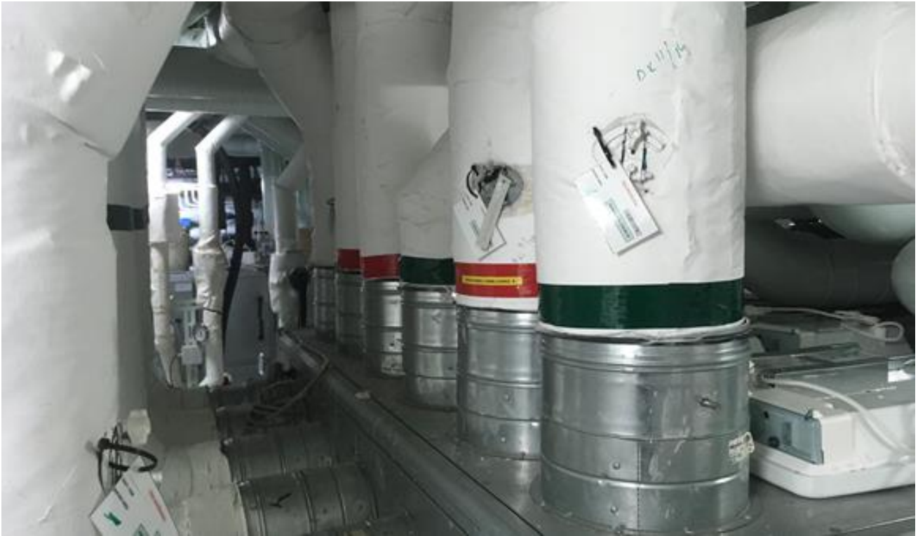
Kuva 11. Ilmanvaihtokanavien merkintä (Timo Lamminen)
