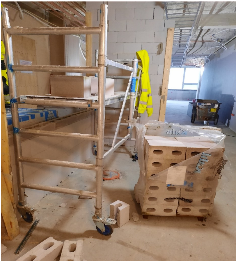
Kuva 8. Telineiden työtaso nostettu liian ylös ilman kaiteita.
