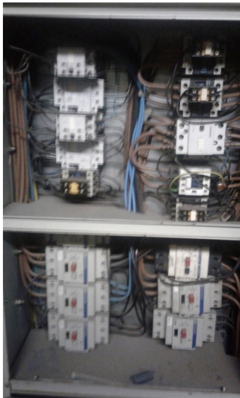
Kuva 18. Nykyinen kiertoilmapuhaltimien suorakäynnistystoteutus
