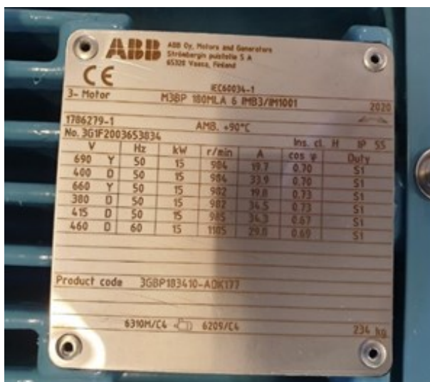
Kuva 20. Kiertoilmapuhaltimen moottorin tyypikilpi
