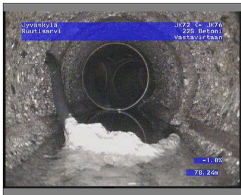
Kuvio 7. Irronneen tiivisteiden kuva TV-kuvausraportissa (L&T viemärikuvausraportti 2014)
