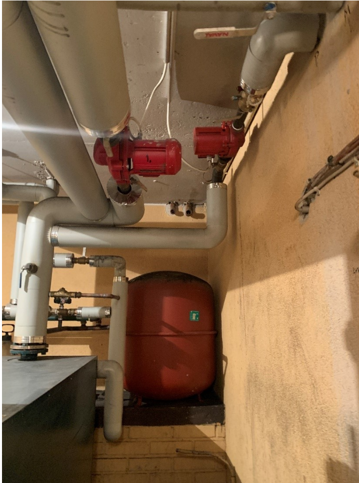
Kuva 11. As. Oy Mutkaheikkilän lämmönjakuhuoneen lämmityspiirit (Taneli Juhola 2020)
