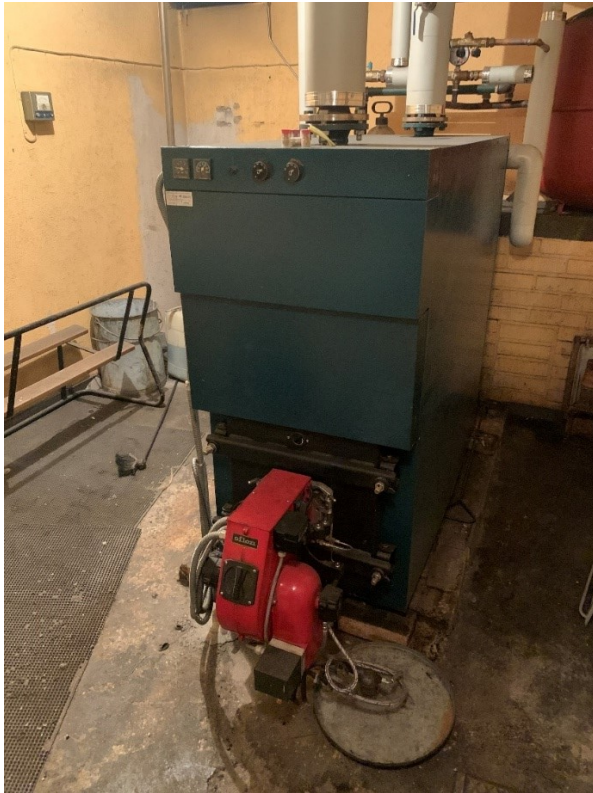
Kuva 9. As. Oy Mutkaheikkilän lämmönjakohuone (Taneli Juhola 2020)
