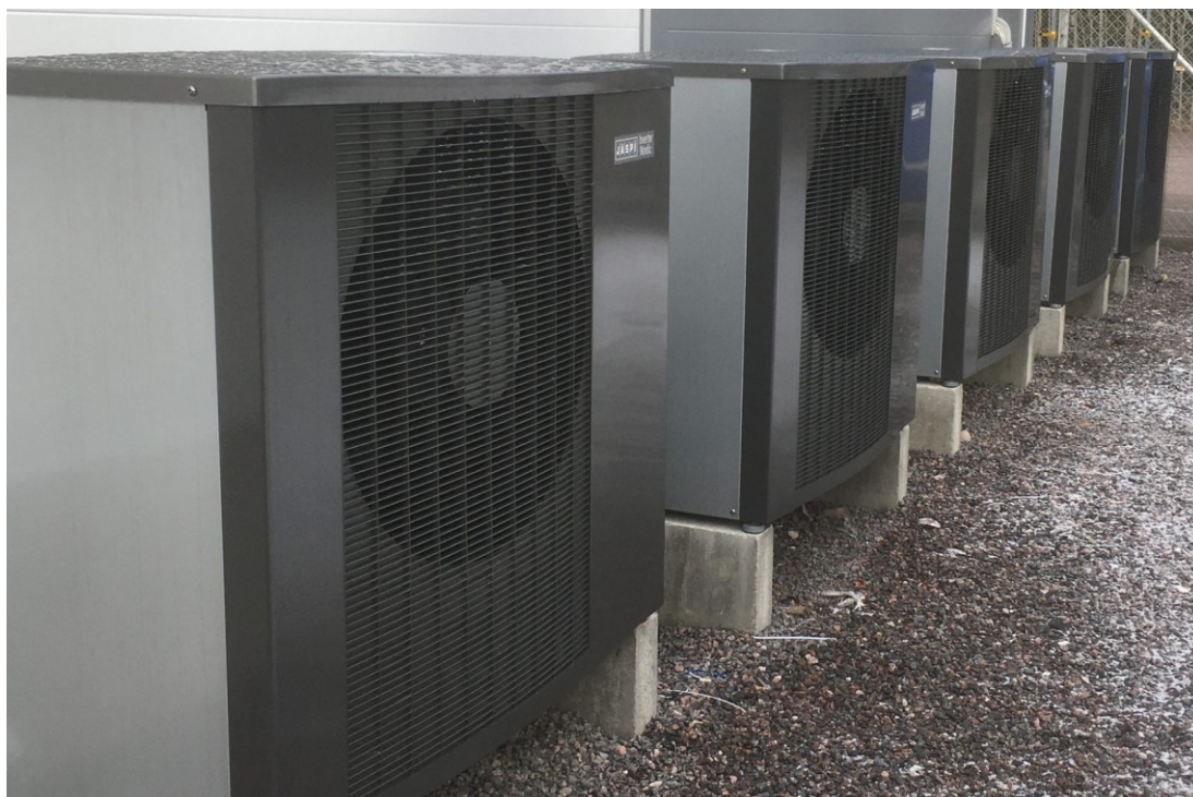
Kuva 3. Jäspi Nordic kiinteistöilma-vesilämpöpumput asennettuna (Kaukora Oy:n www-sivut 2020 muokattu)
