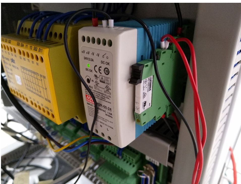
Kuva 7. Pumpun ja venttiilin sähkökytkentä
