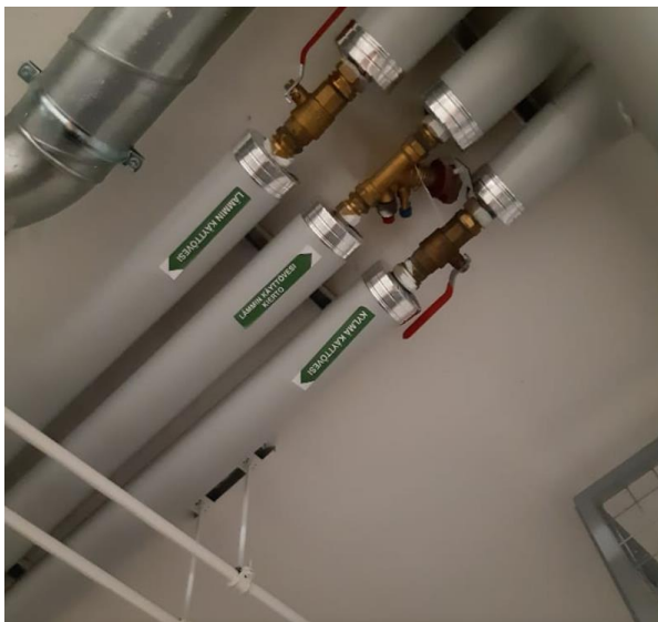
Kuva 8. Laadukkaasti asennettu LVI tekniikkaa. (Kuva Lehto, rakennushanke, 2020).
