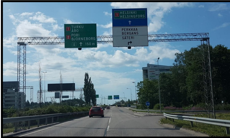
Kuva 8 Ristikkorakenteinen kehäportaali vaihtuvalla elektronisella taululla (Mapillary, n.d)
