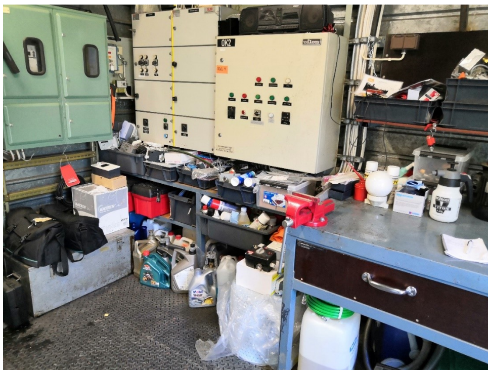
Kuva 8. Lämpölaitoksen työpiste ja varastointitila.
