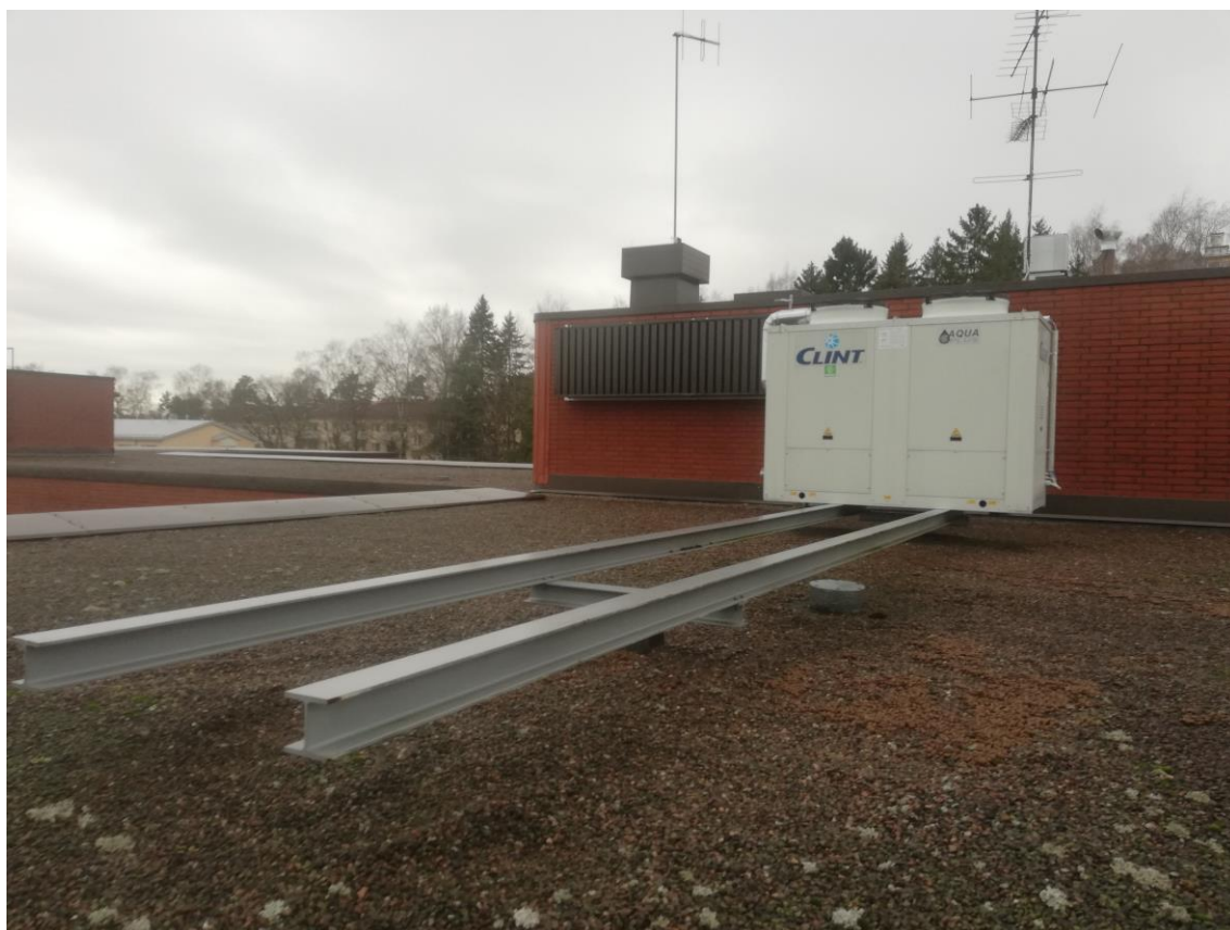
Kuva 9. Vesikatolla sijaitseva vedenjäähdytyskone JK02 ja kerroskohtaisia jäähdytyslaitteita varten asennetut petivaraukset. Taustalla IV-konehuone TK06:n ulkoilmakammion lumikilpi ja jäteilmalaite.
