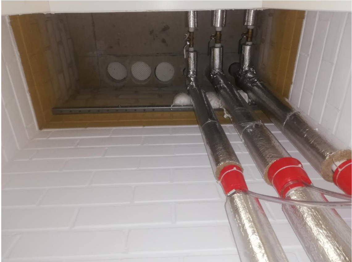
Kuva 7. Uudet putkinousut, vuodonilmaisimet ja tilavaraukset ensimmäisen kerroksen kome-rossa.
