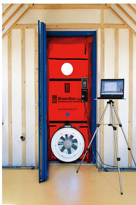
Bild 2. Blower door ( http://www.blowerdoor.de/en/blowerdoor/standard.html )
