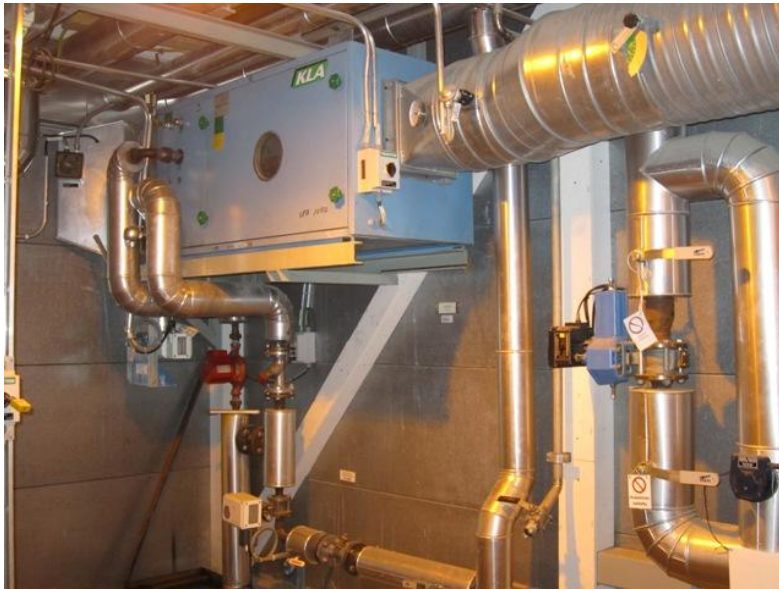
Kuva 8. POK-säiliön pumppaamon tuloilmakoje
