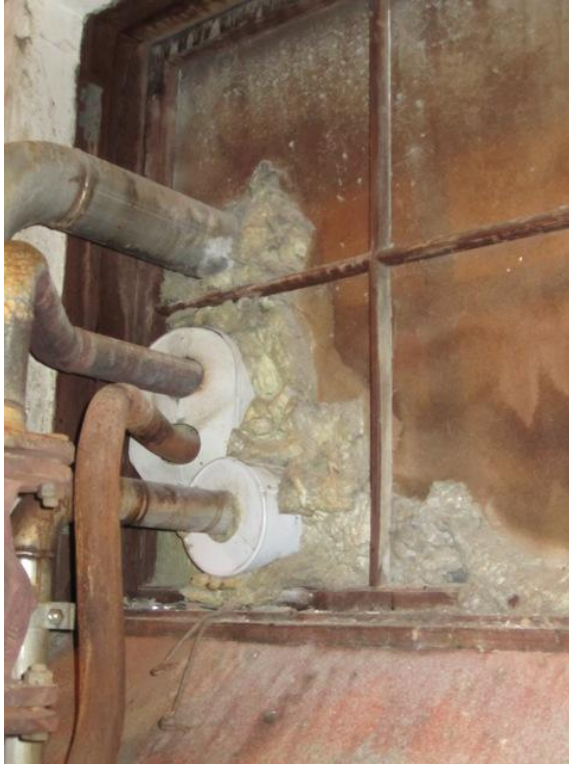
Kuva 14. Vesilaitoksen putkien läpivientejä
