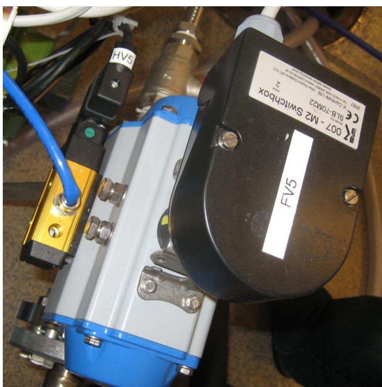
Kuva 8. Rajakytkinkyksikkö FV5, magneettiventtiili HV5 ja pneumaattinen toimilaite
