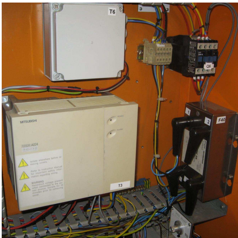
Kuva 19. Taajuusmuuttaja T3, EMC-suojaja F40 sekä pulssimuunnin T6
