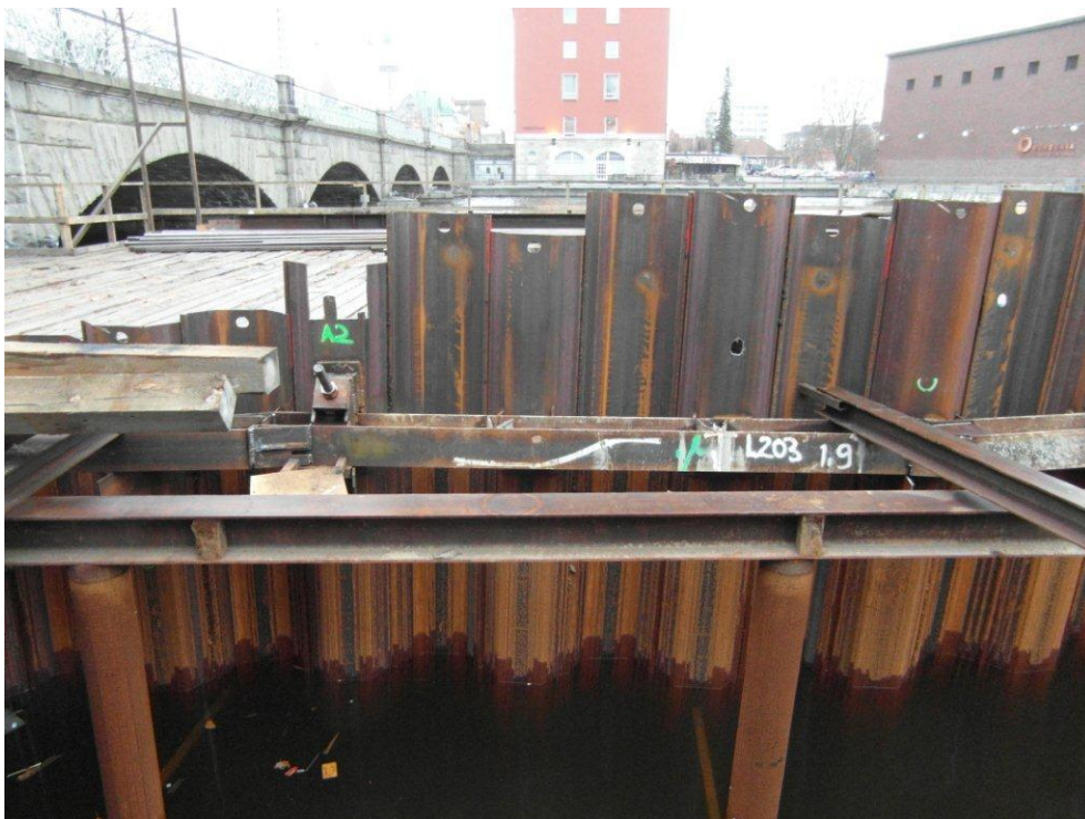
Kuva 21. Patotyömaa. Ponttiseinä alkanut kallistua.
