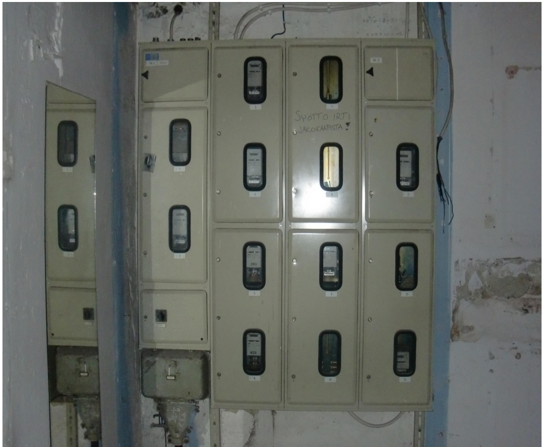
KUVA 1. As Oy Mikkelin Huopatehdas kiinteistön vanha pääkeskus
