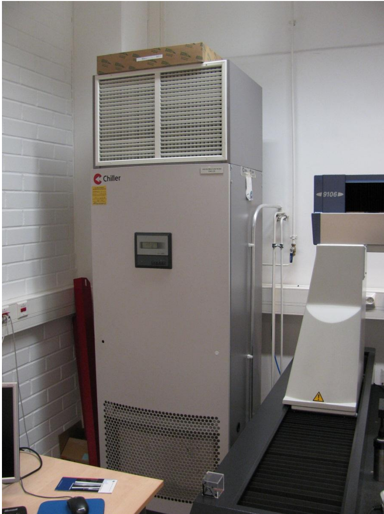
Kuvio 18. Kuva mittaushuoneen ilmastointilaitteesta
