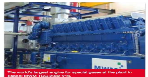
MWM Engin in Ammässuo LFGTE
