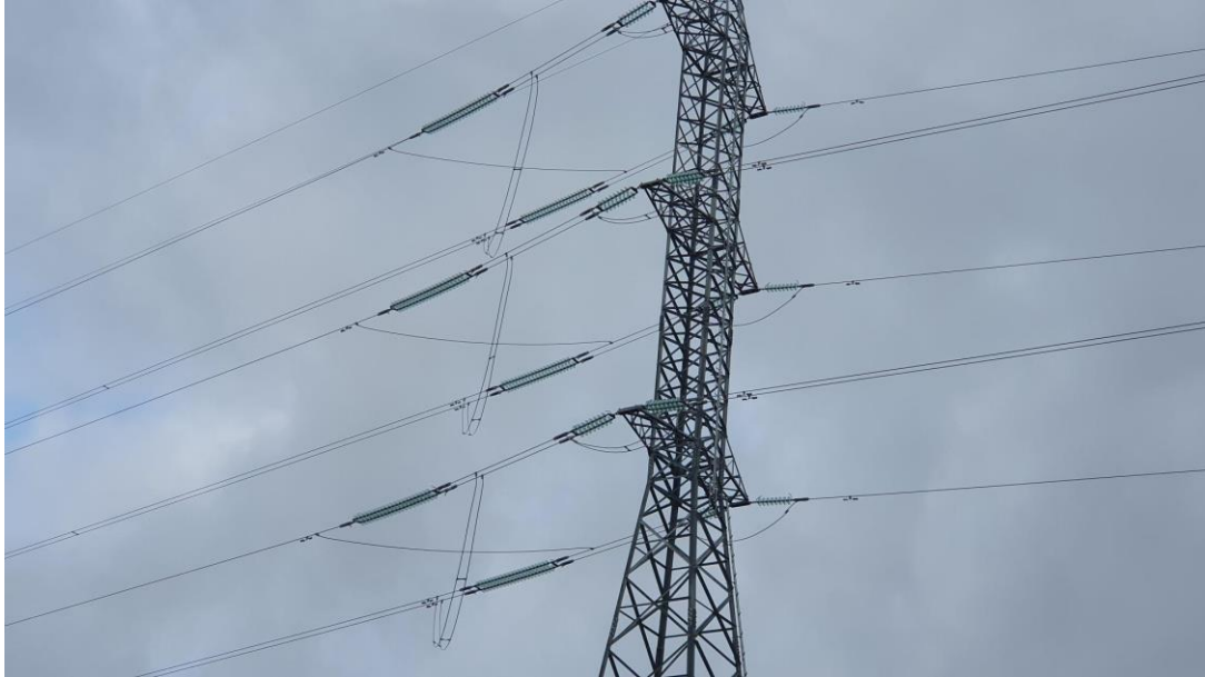
Kuva 6. Kuvassa kiristyspylvään virtajohtimet ovat yhdistetty jompeilla, sekä virtapiirienvuorottelu toteutettuna jomppien avulla.
