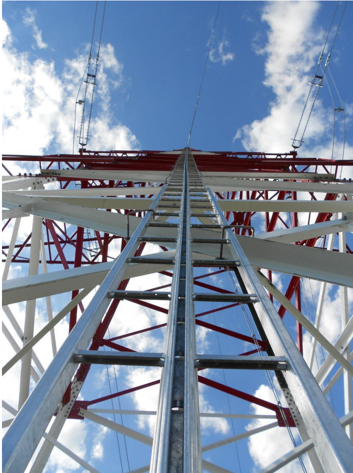
Kuva 10. Kuvassa pylvääseen asennetut turvatikkaat, joihin asentaja kiinnittää itsensä kiivettäessä pylvääseen.
