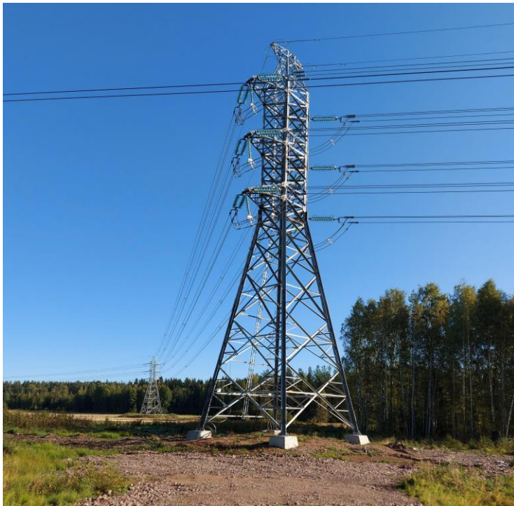
Kuva 3. Kuvassa Eltelin suunnittelema ja rakentama vapaasti seisova kiristyspylväs.
