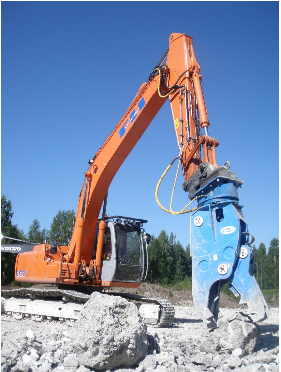
Kuva 38. Betonin pulverointia. Valokuva Mikael Gull 2011
