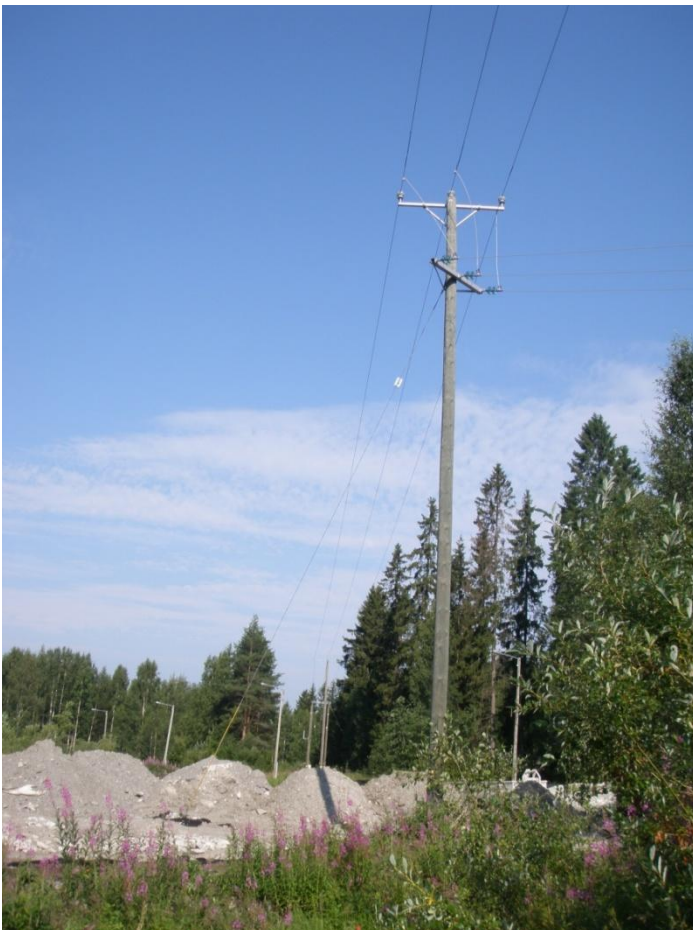
Kuva 41. Sähköjohto rakennettavan tontin yllä.
