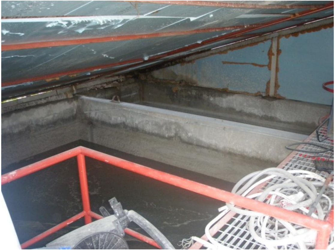
Kuva 34. Suojattu sisäallas, josta kierrätysvesi otetaan säiliöiden pesuun. Allas on noin 4 metriä syvä. Valokuva Mikael Gull 2011
