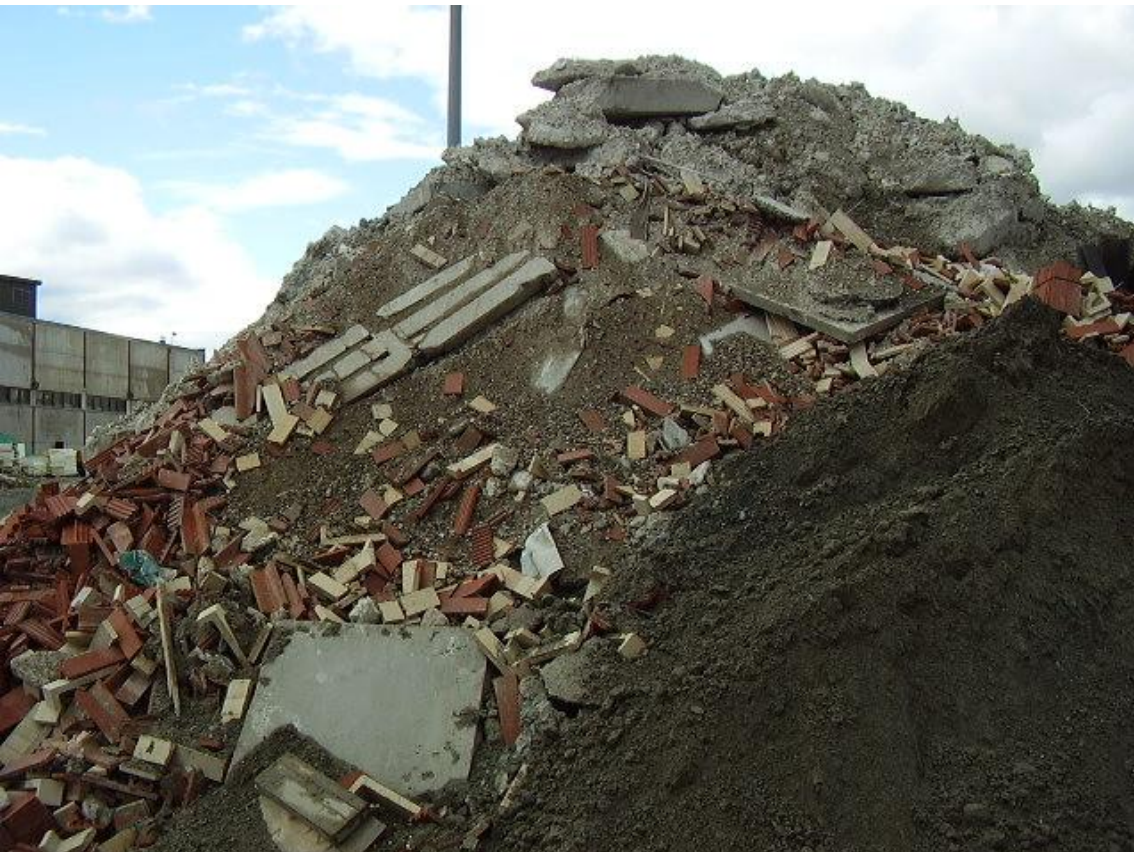
Kuva 30. Sekalaista ylijäämäbetonia tehtaan pihakentällä. Valokuva Mikael Gull 2011
