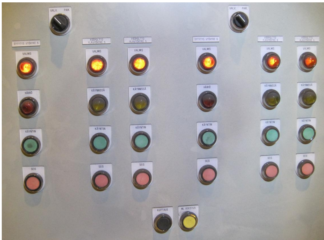
KUVA 6. Ohjauskaapin paikallisohjauskytkimet, sekä merkkilamput
