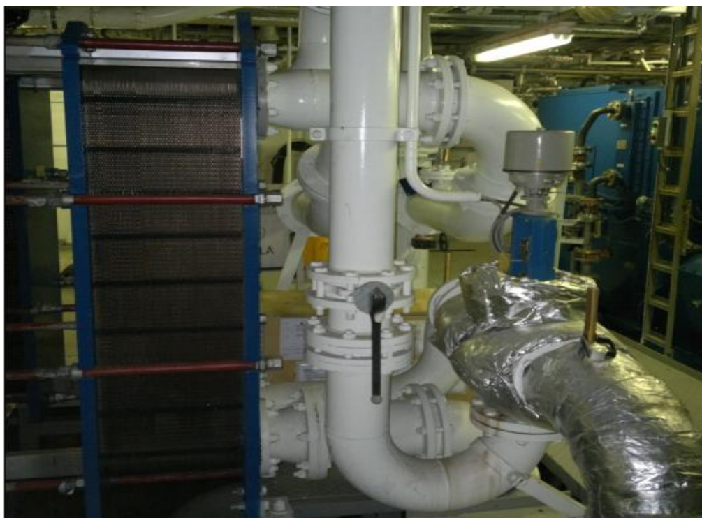
Kuva 7. Keskusjäähdytin ja termostaattiventtiili kytkentöineen.
