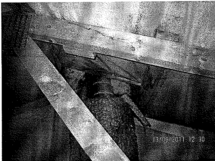
Kuva 10. Ilmanvaihdon läpiviennin kohdalla on vuotojälkiä puurakenteissa.
