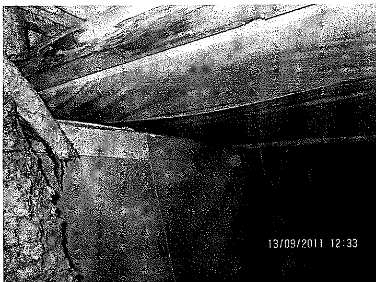
Kuva 12. Palokatkoseinä ei ulotu vesikatteeseen asti.
