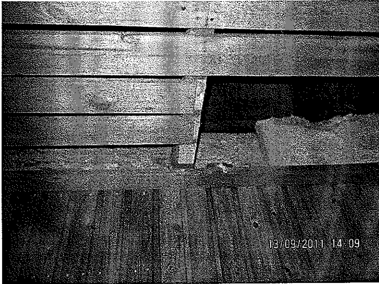
Kuva 9. Ulkoseinän kovavilla ei ylety yläpohjaeristeiden yläpintaan asti joka kohdassa ulkoseinällä.
