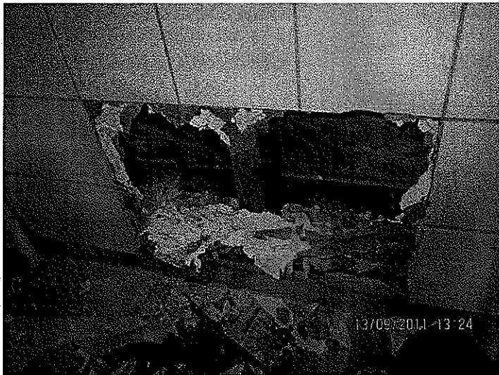
Kuva 8. Väliseinässä ei ole ollenkaan lämmöneristeitä.
