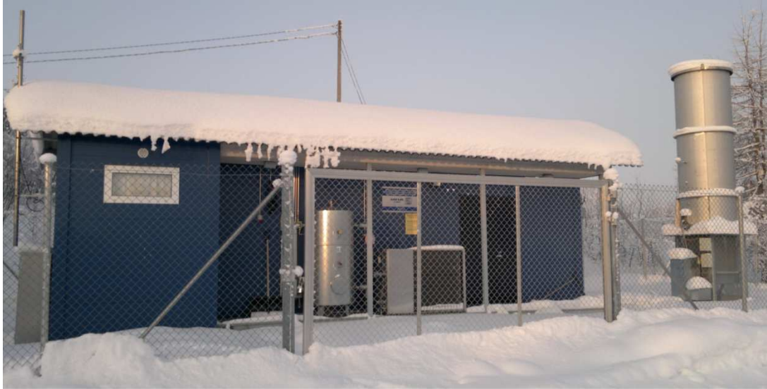
KUVA 3. Rovaniemen Mäntyvaaran biokaasupumppaamo
