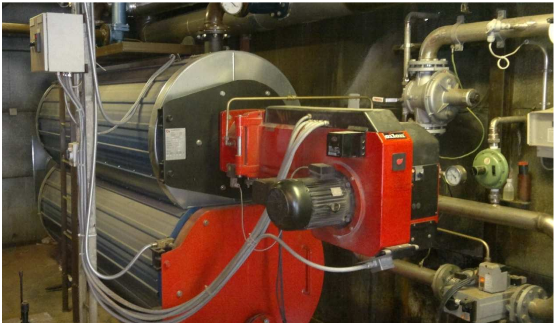
KUVA18. Hillerintien biokaasupoltin ja kattila
