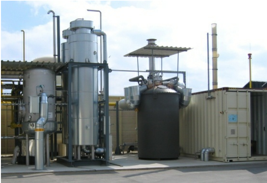
Kuva 5. Vasemmalla biokaasun puhdistuslaitteistoa ja oikealla heikkokaasun liekitön hapetuslaite. (Kuva: Ritva Imppola)
