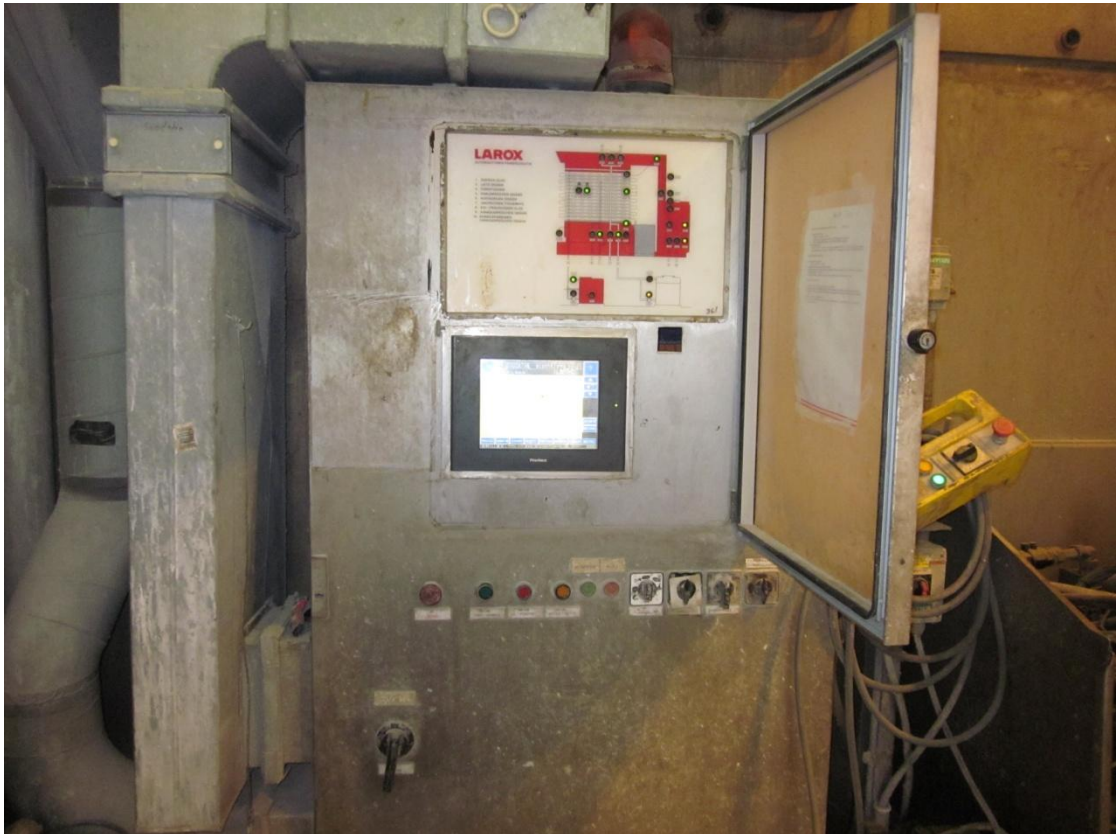
KUVA 10. Larox-painesuodattimen ohjauskeskus (Joonas Rautiainen 2011)
