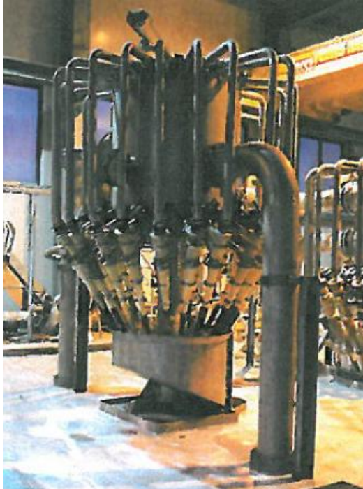
Kuva 28. Hydrosyklonipatteristo (Boliden) /9, s. 48/
