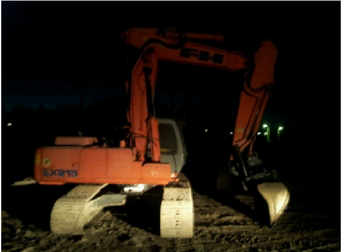
Kuva 7. Kuvassa näkyy Maajukka Oy:n tela-alustaisen kaivinkoneen Fiat Hitachin kolmoistaittopuomi Jyväskylän Lutakon työmaan alkuvaiheen kaivauksissa.
