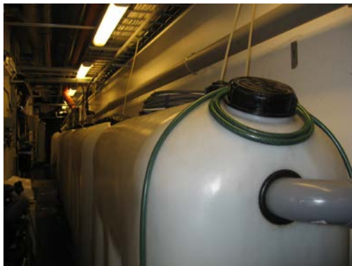
KUVA 7. Alhaalla vasemmalla P5 puhdistettun veden säiliö
